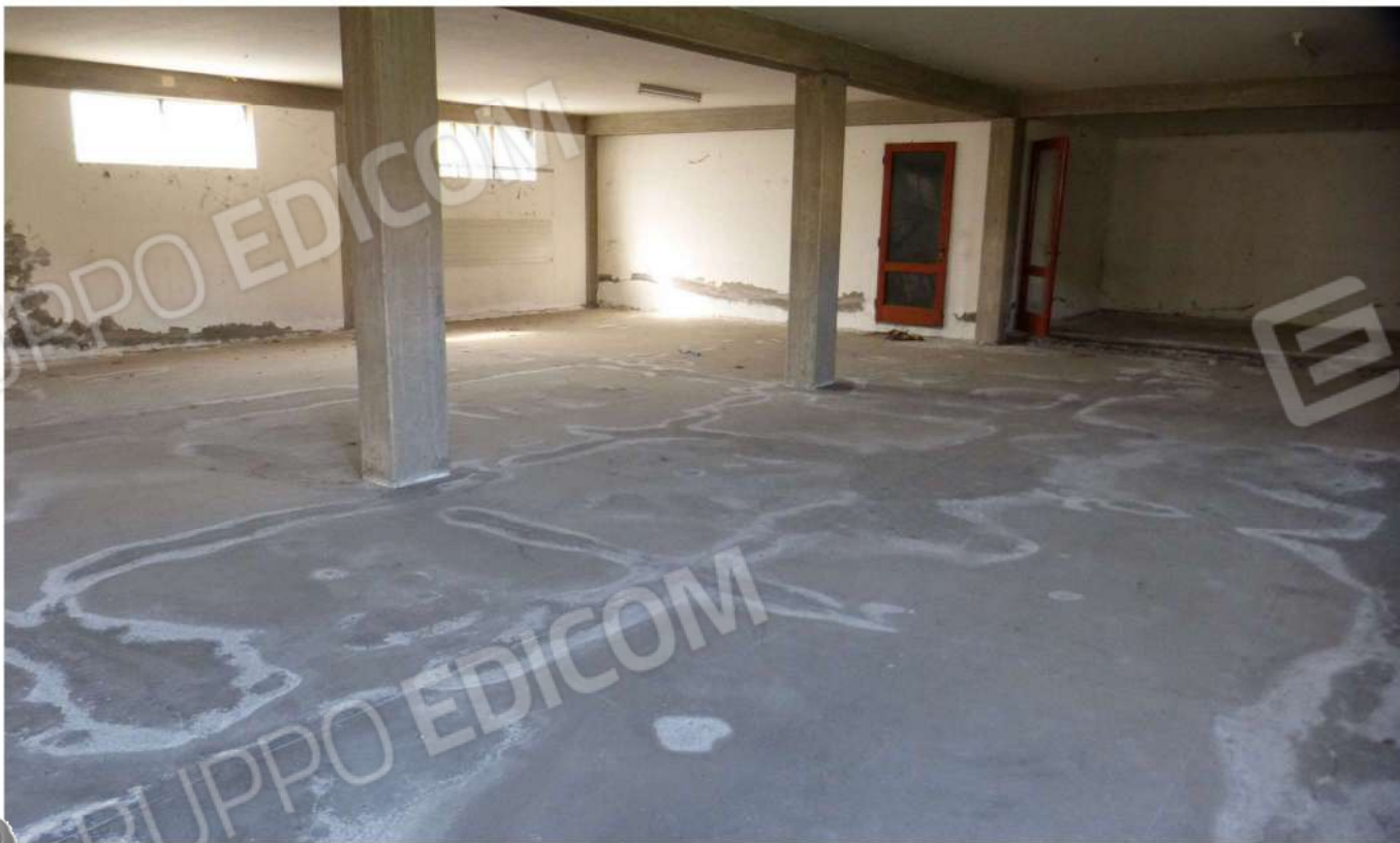
particolare e risalita capillare dell'umidità - degrado pavimentazione e parti basamentali
