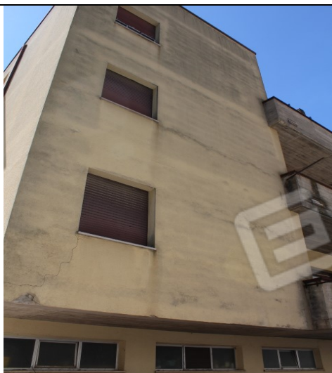
PARTICOLARE LESIONI SUL PROSPETTO NORD
