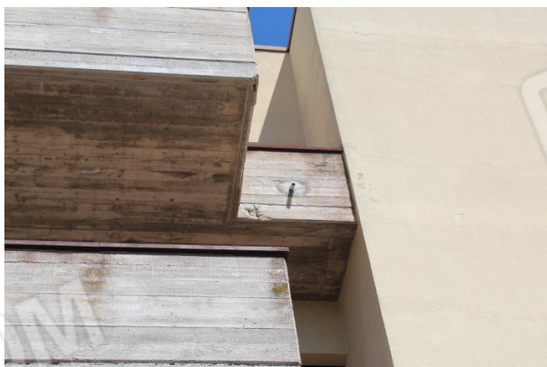
PARTICOLARE DISTACCHI DI CALCESTRUZZO
