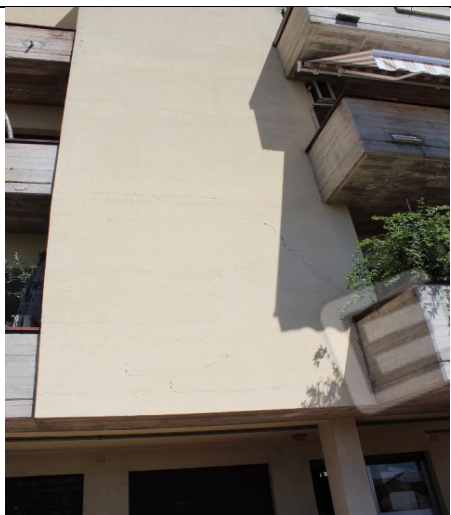
PARTICOLARE MURATURA CON LESIONI
