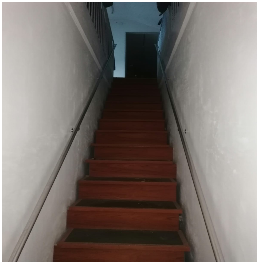
Scala in legno ( autoportante )
