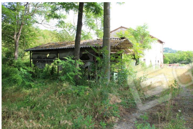
TETTOIA ABUSIVA, VISTA DA SUD VERSO NORD, DA DEMOLIRE INTEGRALMENTE
