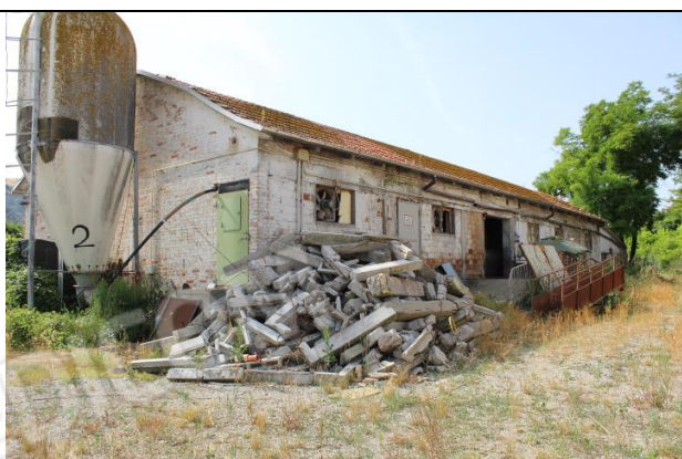
PROSPETTO OVEST ALLEVAMENTO CON CUMULO MACERIE DA SMALTIRE IN DISCARICA AUTORIZZATA
