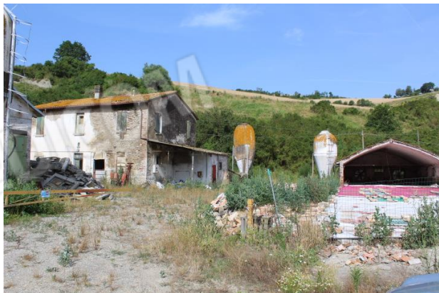
VISTA ALLEVAMENTO IN PARTE CROLLATO E CASA COLONICA SUL RETRO
