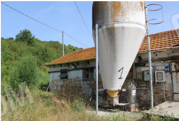
PARTICOLARE SILOS ALLEVAMENTO IN PARTE CROLLATO CON IMPIANTI ELETTRICI RESIDUI
