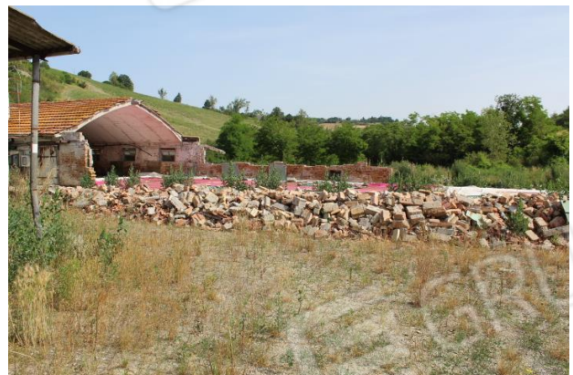
ALLEVAMENTO CROLLATO; PARTICOLARE MACERIE DA SMALTIRE IN DISCARICA AUTORIZZATA
