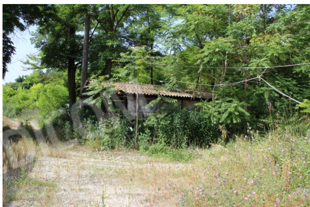
TETTOIA ABUSIVA DA DEMOLIRE INTEGRALMENTE
