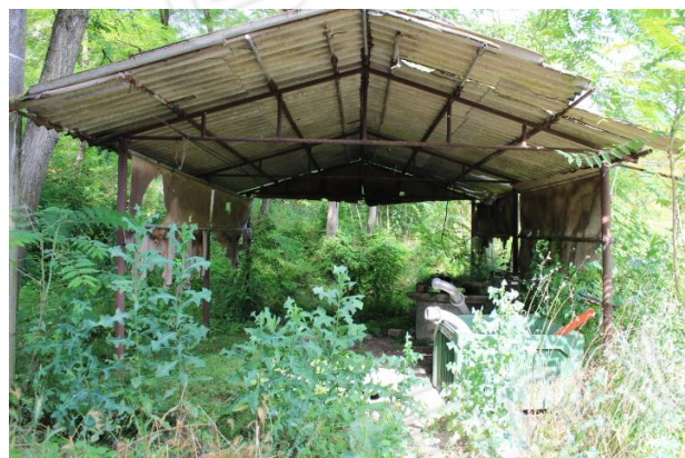
TETTOIA ABUSIVA DA DEMOLIRE INTEGRALMENTE
