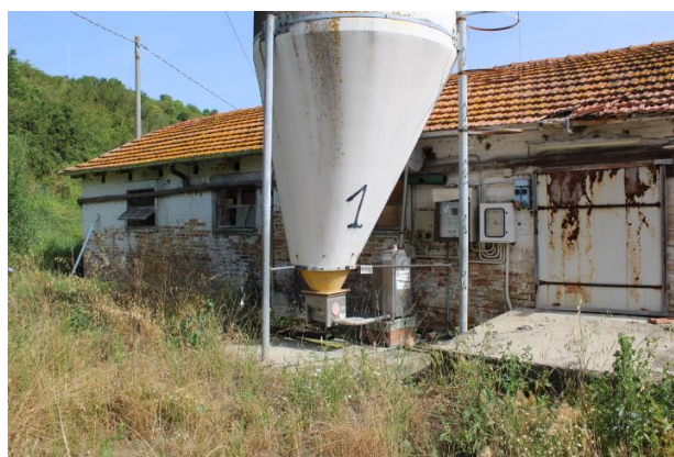
PARTICOLARE ALLEVAMENTO CORPO 2 NON CROLLATO, CON SILOS ED IMPIANTO ELETTRICO
