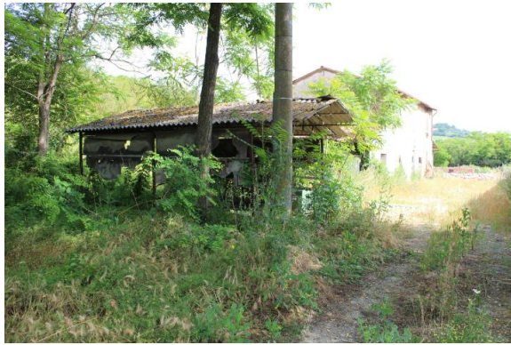
TETTOIA ABUSIVA DA RIMUOVERE INTEGRALMENTE, VISTA DA SUD VERSO NORD
