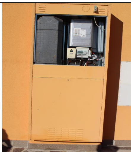
CALDAIA DEL RISTORANTE CHE L'ESECUTATO HA DICHIARATO NON ESSERE FUNZIONANTE
