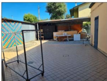
FOTO 19 - VISTA DELLA TETTOIA NON LEGITTIMA
