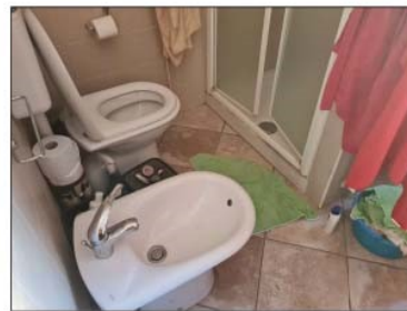
FOTO 63 - BAGNO PIANO INTERMEDIO
