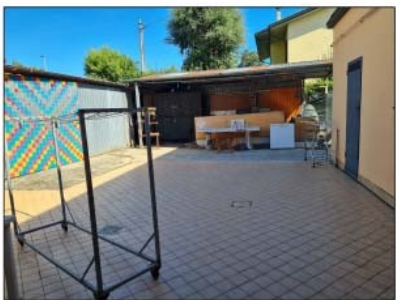
FOTO 19 - VISTA DELLA TETTOIA NON LEGITTIMA
