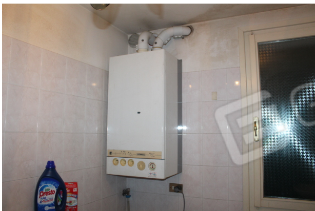
PARTICOLARE DELLA CALDAIA
