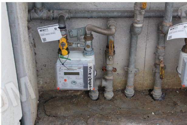
PARTICOLARE DEL CONTATORI DEL GAS RELATIVO ALL'U.I. OGGETTO DI PROCEDURA
