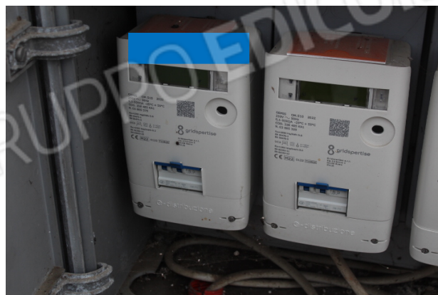
PARTICOLARE DEI CONTATORI DELL'ENERGIA ELETTRICA
