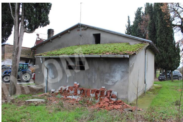
ABITAZIONE VISTA DA NORD. COPERTURA DEL RIPOSTIGLIO IN PARTE CROLLATA
