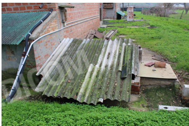
PARTICOLARE LASTRE DI ETERNIT ACCATASTATE E DA SMALTIRE
