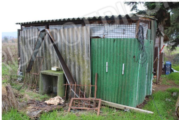
MANUFATTO ABUSIVO, POSTO A NORD DELL'ALLEVAMENTO
