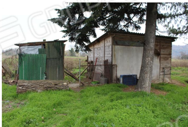
VISTA D'INSIEME DEI DUE MANUFATTI ABUSIVI
