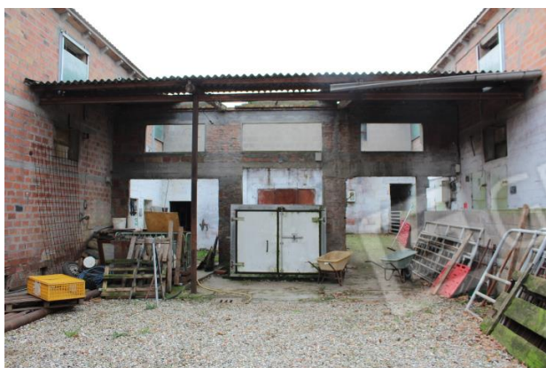
PARTE CENTRALE, VISTA DA NORD, CON MANTO DI COPERTURA IN ETERNIT, CROLLATO
