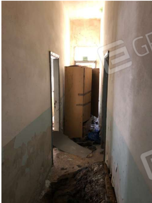
Vista disimpegno con uscita di sicurezza su prospetto sud al piano terra.
