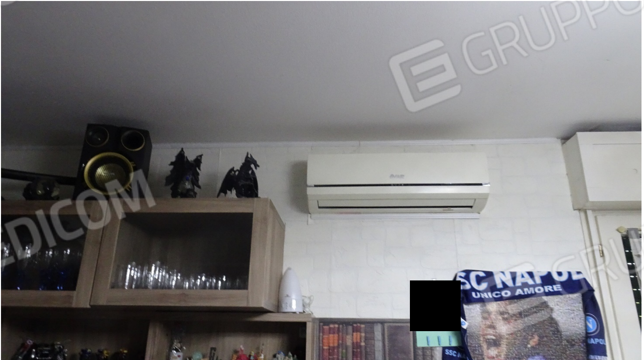
Foto 21_particolare aria condizionata
