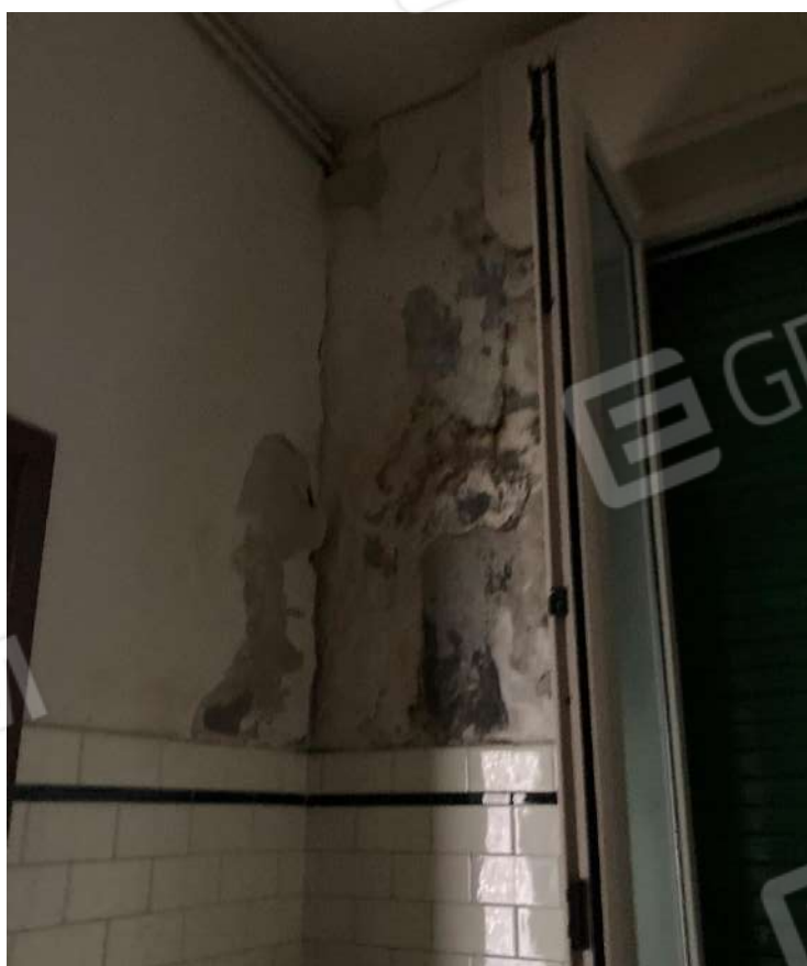
Infiltrazione di acqua nell'angolo del bagno.
