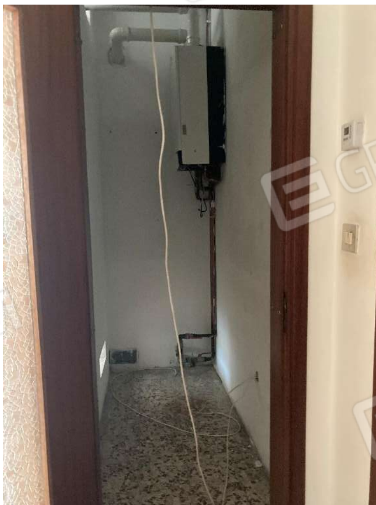
Vista del ripostiglio in cui è presente la caldaia.
