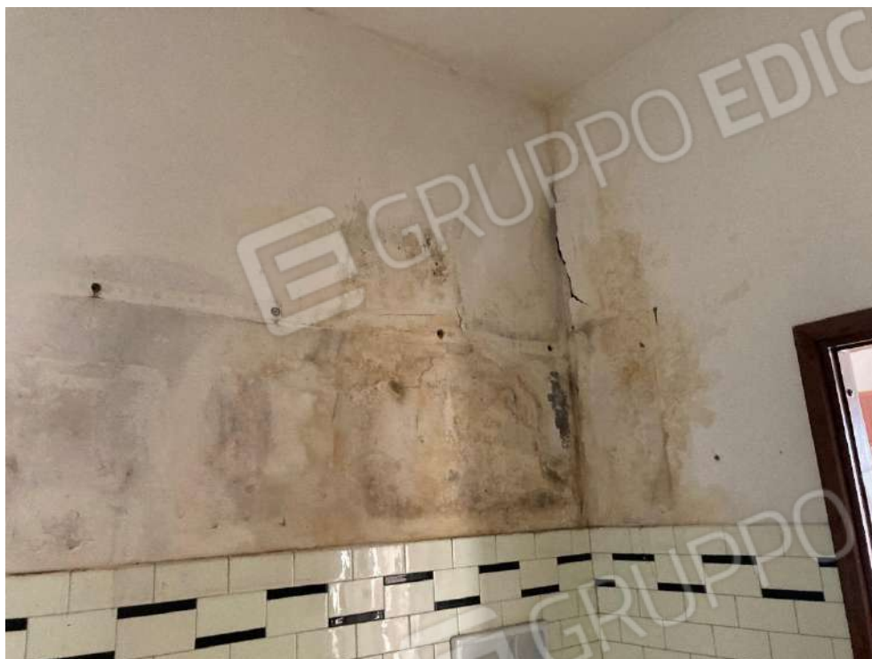
Infiltrazione di acqua nell'angolo della cucina.
