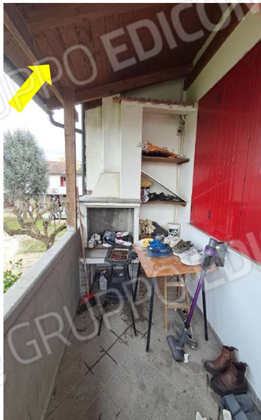
BALCONE CON CAMINETTO E TETTOIA NON AUTORIZZATA
