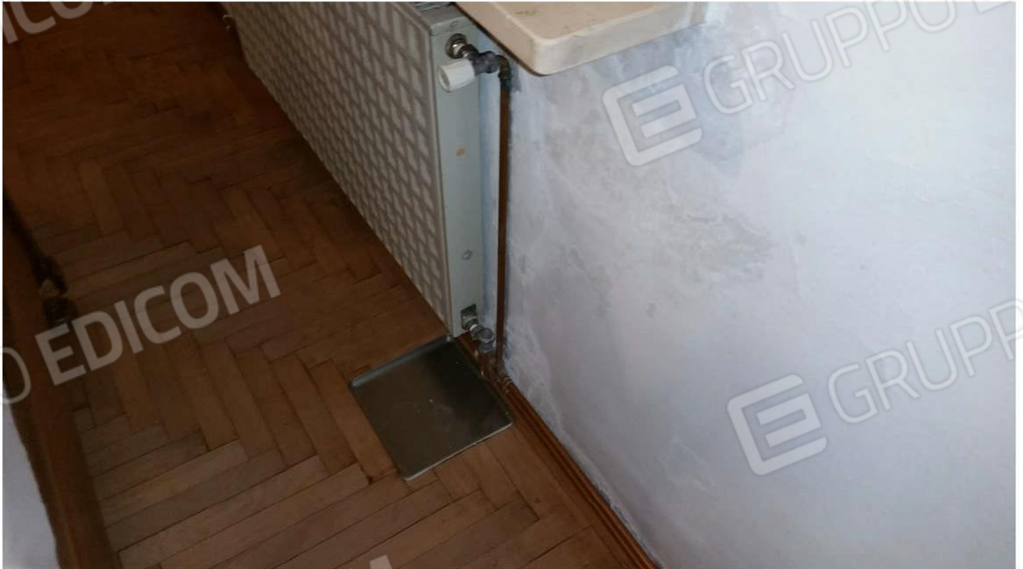
22-Lotto 2 - particolare riscaldamento
