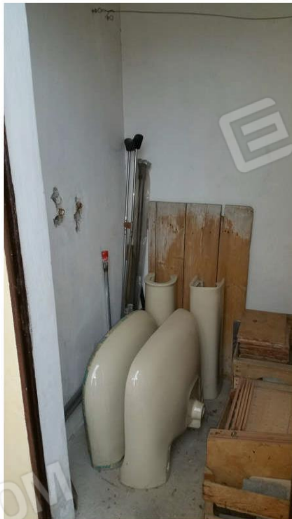
18-Lotto 1 - vano caldaia
