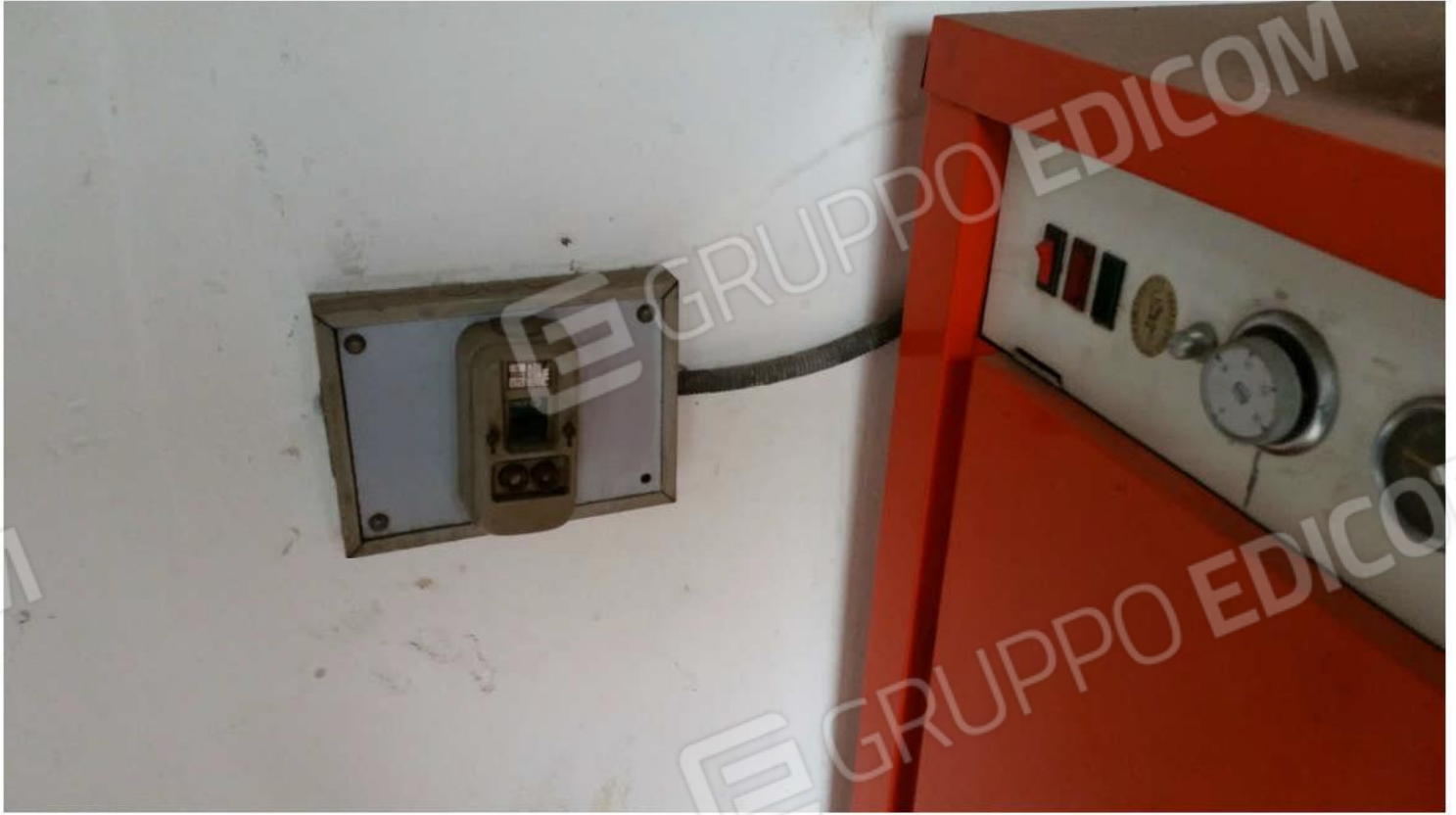
21-Lotto 2 - particolare imp elettrico caldaia
