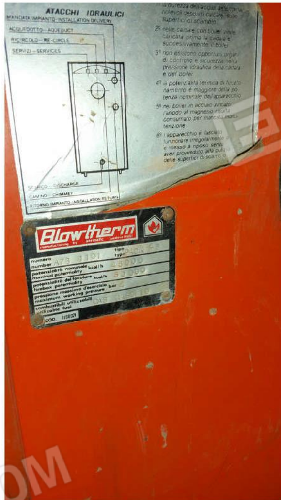
20-Lotto 2 - caldaia gasolio 2
