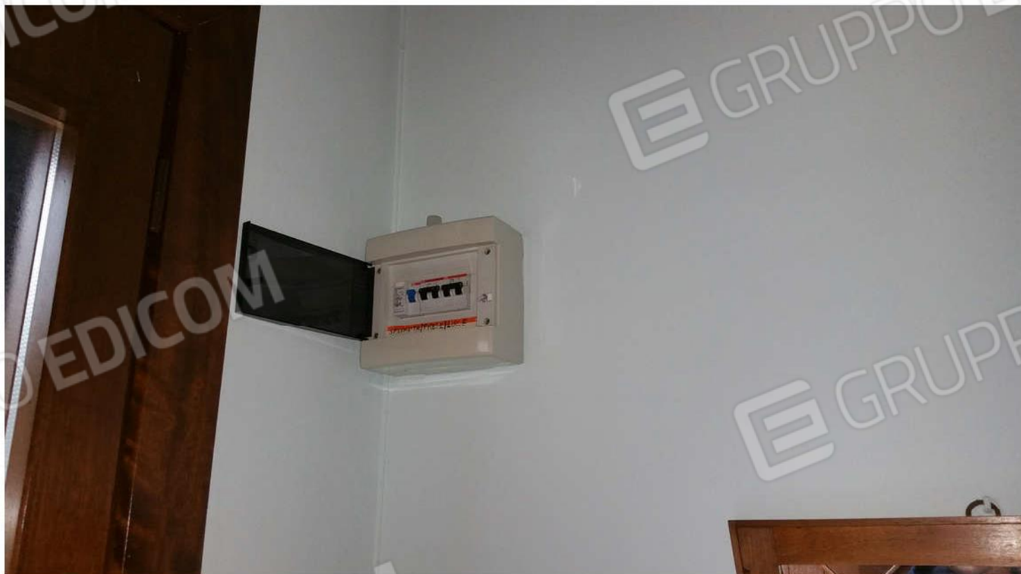
24-Lotto 2 - quadro elettrico
