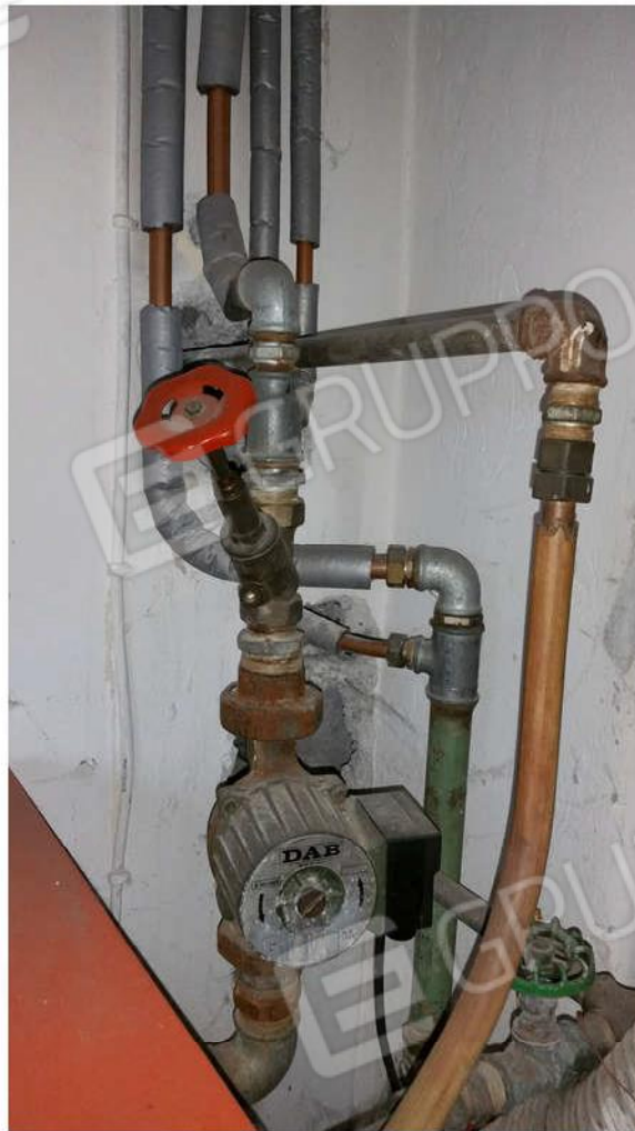
23-Lotto 2 - pompa caldaia
