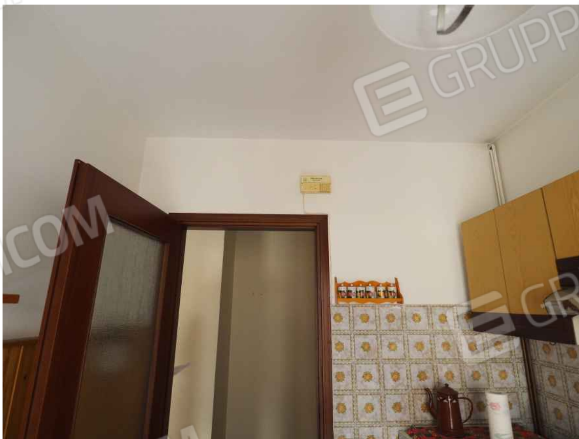
Azzano Decimo, via Mores di Sotto n. 5 int. b – Sopra il quadro elettrico, sotto il rilevatore di gas.
