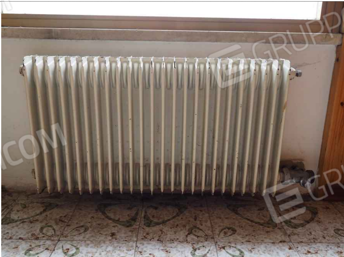
Azzano Decimo, via Mores di Sotto n. 5 int. b – Particolari del condizionatore e del radiatore.
