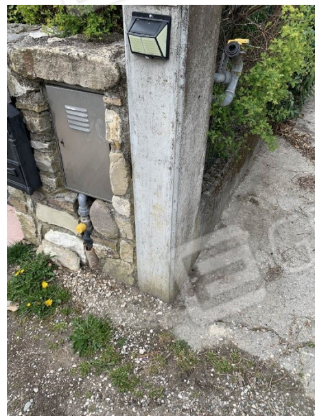
particolare della predisposizione dell'allacciamento alla rete gas metano
