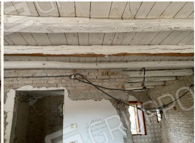
particolare del vetusto impianto elettrico
