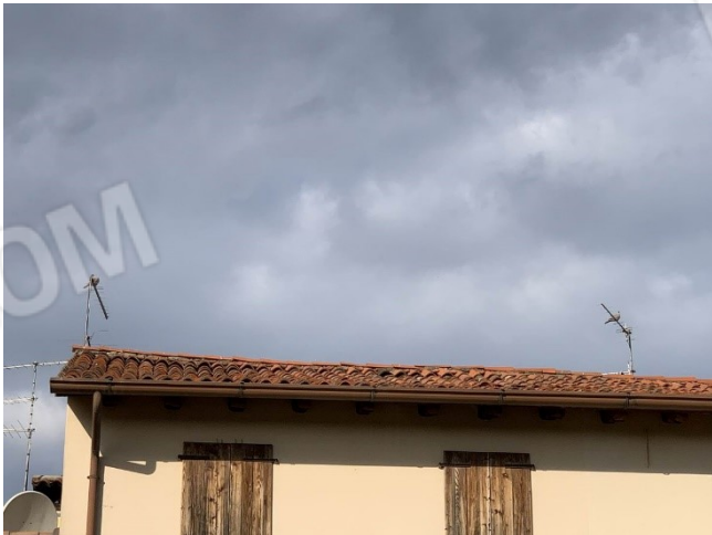
particolare vetusta copertura con cedimenti causa di infiltrazioni d'acqua
