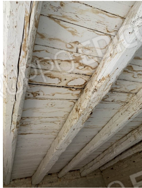
particolare del secondo solaio in legno con tracce di infiltrazioni d'acqua
