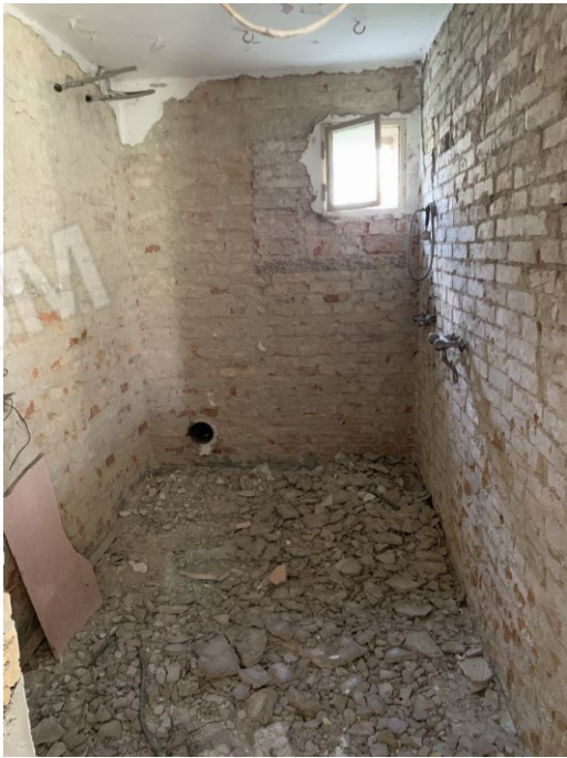
vista della centrale termica/lavanderia
