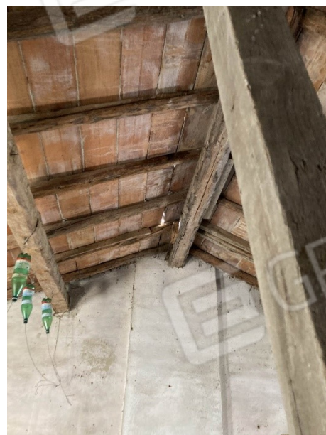
vista del vetusto tetto in legno con cedimenti strutturali e causa di infiltrazioni d'acqua
