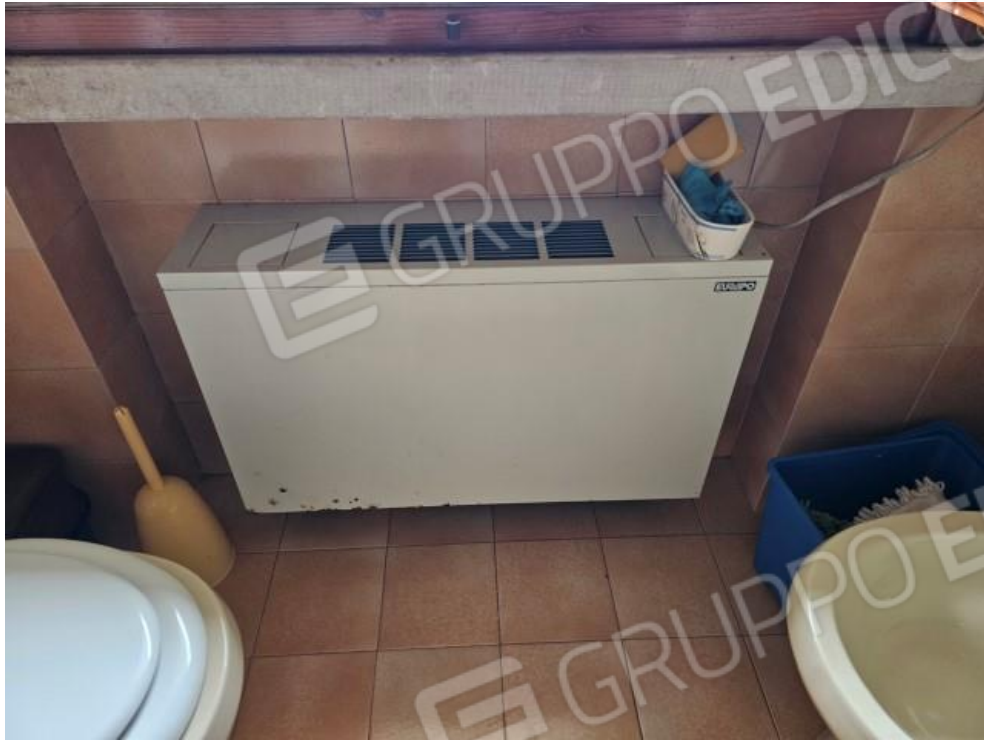
FOTO 21: PARTICOLARE VENTILCONVETTORE (SUB. 10 – 1°P.)
