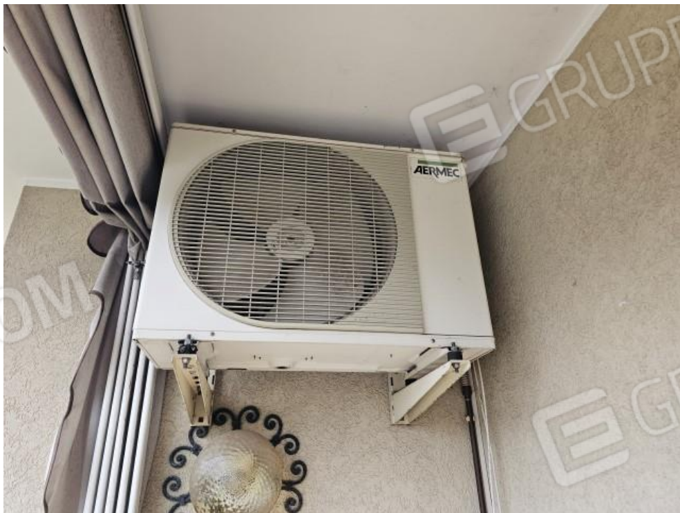
FOTO 22: UNITA' ESTERNA CLIMATIZZATORE (SUB. 10 – 1°P.)
