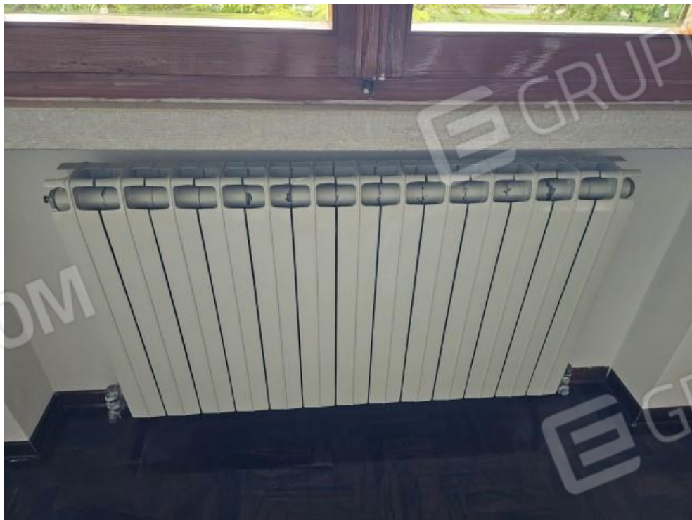
FOTO 20: PARTICOLARE TERMOSIFONE (SUB. 10 – 1°P.)
