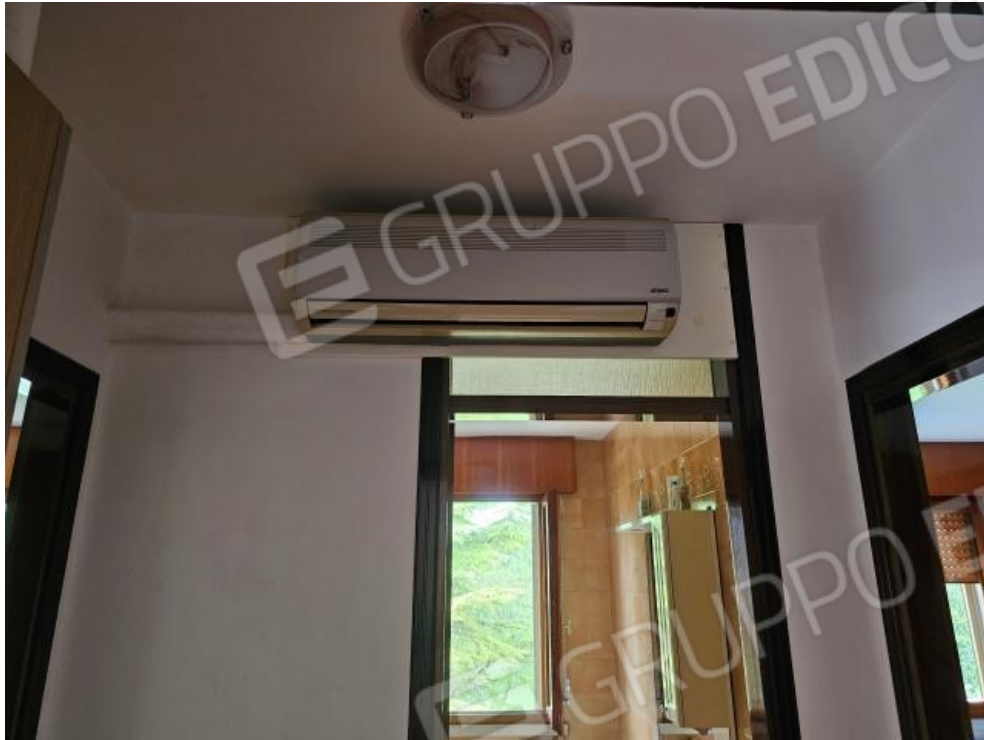
FOTO 23: UNITA' INTERNA CLIMATIZZATORE (SUB. 10 – 1°P.)
