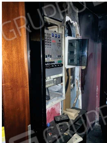
vista zona quadri elettrici nel corridoio tra bar e retro-bar
