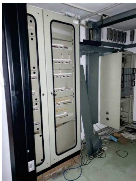
vista ripostiglio quadri elettrici al piano seminterrato
