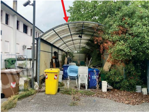
ulteriore particolare della tettoia abusiva lato Sud
