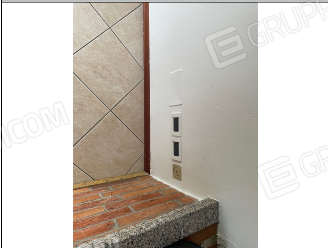
Particolare impianto elettrico e finiture parete
