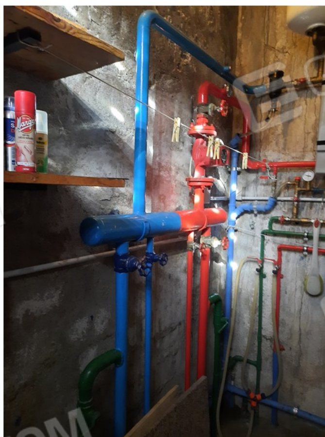
16A - centrale termica
