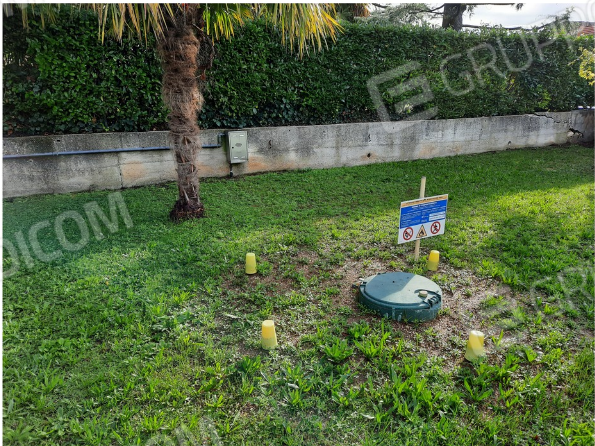
18 - serbatoio gas gpl
