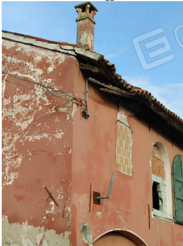
Foto 7 – Vista tetto danneggiato – lato cortile
