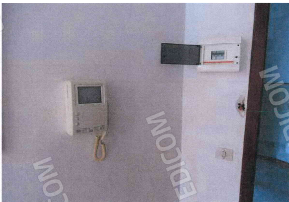
Foto 3: Quadro elettrico e citofono nell'ingresso
