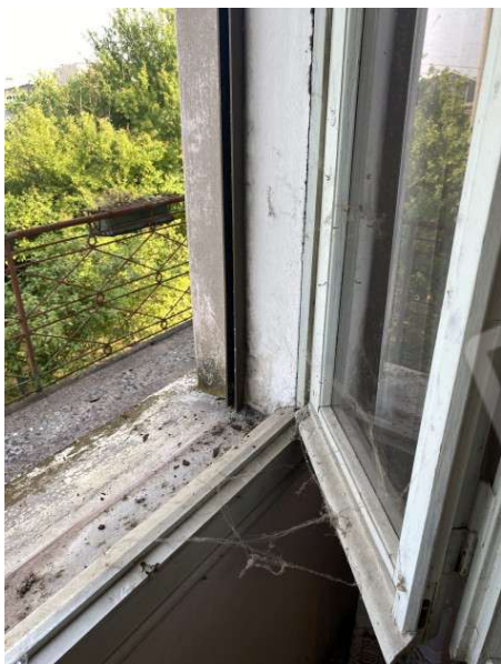
vista degrado serramenti
