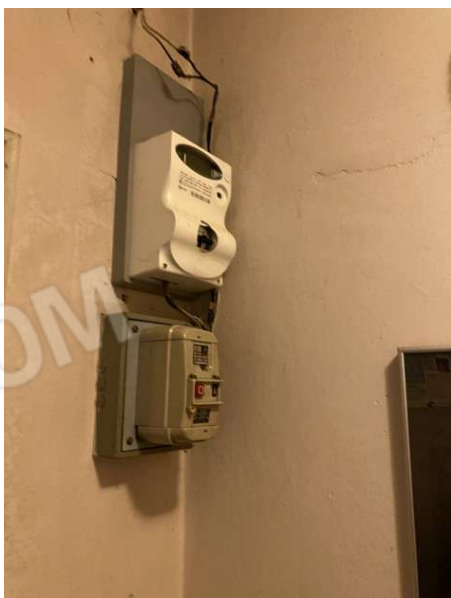
vista unico contatore elettrico
