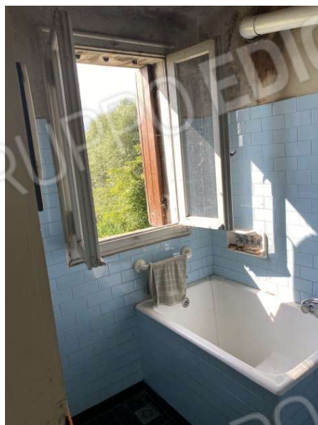
vista interna muffa nel bagno
