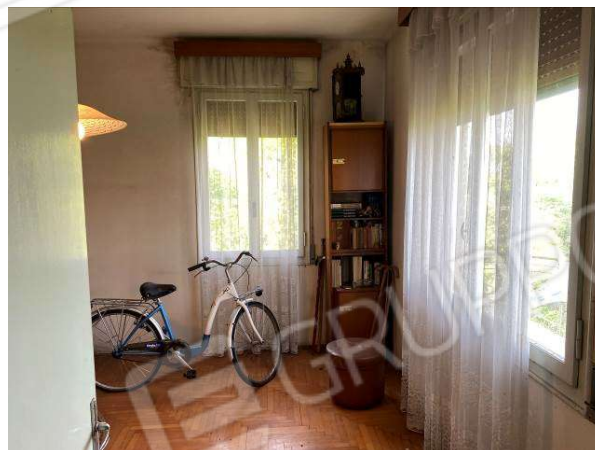
vista interna muffa nella camera a nord/est
