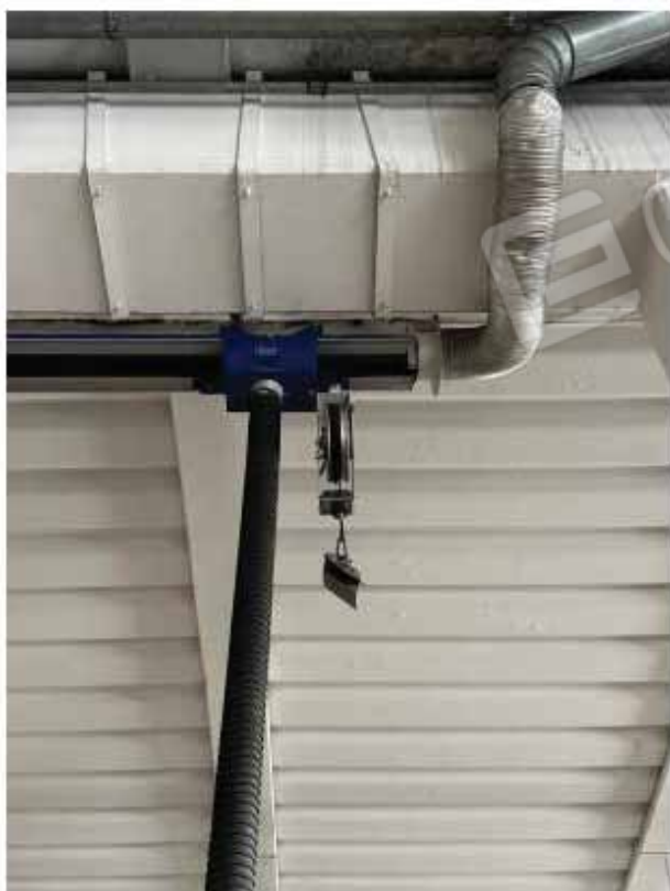
ID 0297 + 0298 + 0299 + 0300 aspiratore gas di scarico con raccogliore di cui uno scorrevole su guida aerea
