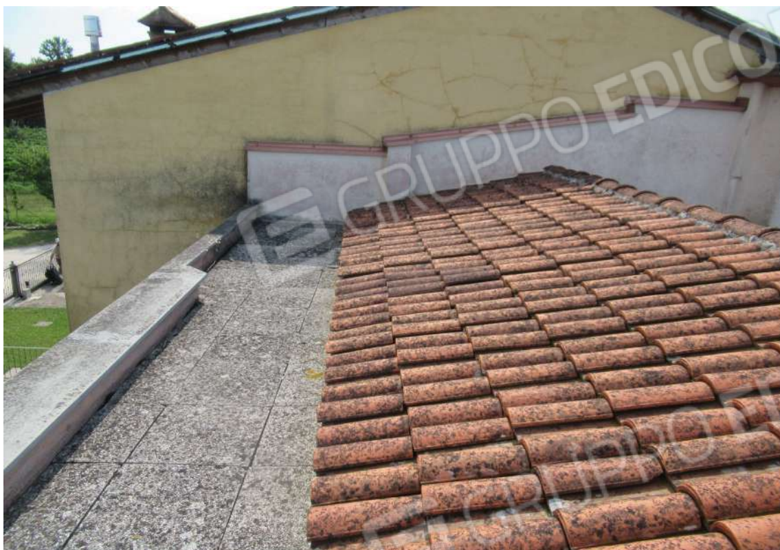
Foto 22: Tetto primo piano abitazione
