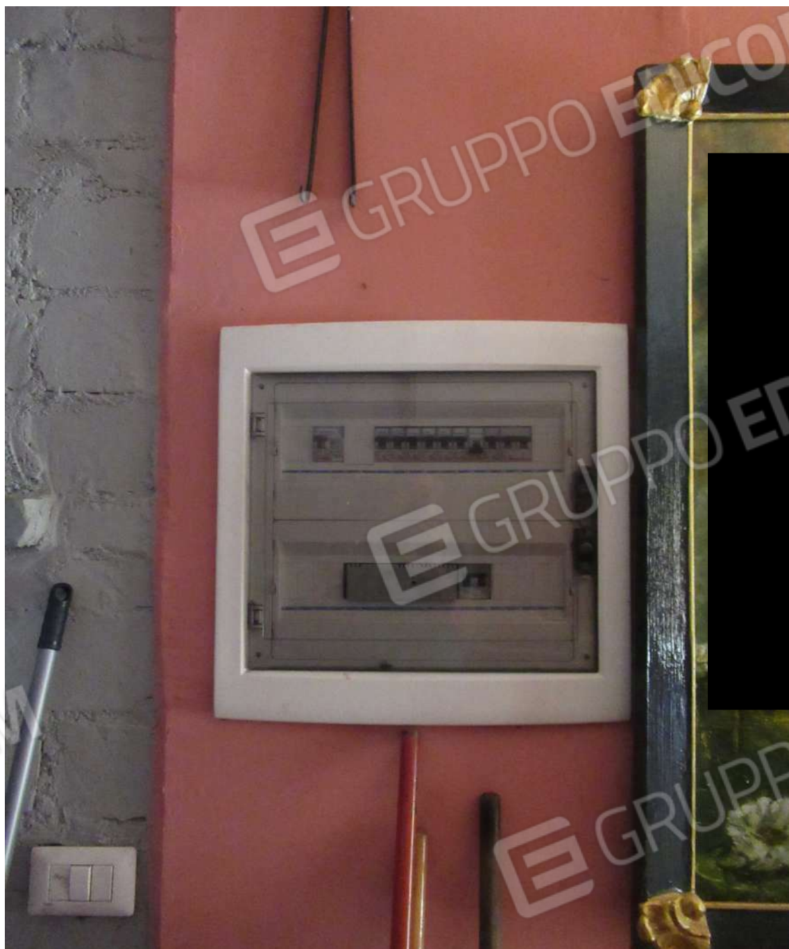
Foto 21: Quadro elettrico in garage
