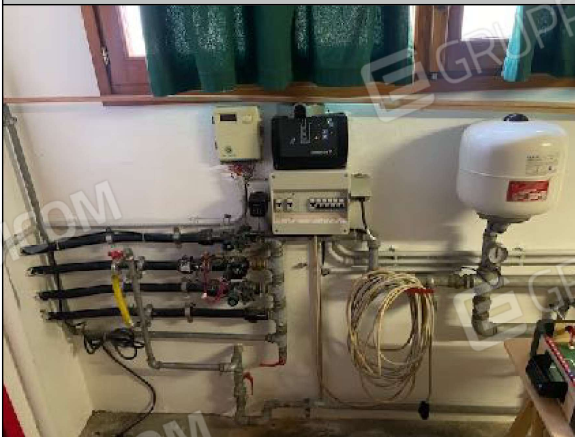
Cantina: dettaglio contatore
