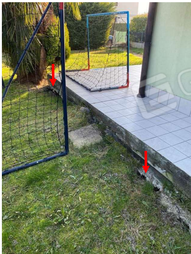
ulteriore vista cedimento terreno circostante al fabbricato di circa 25 cm
