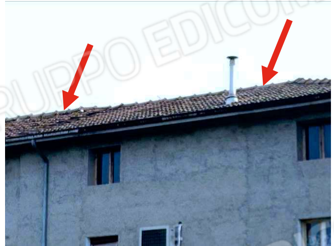
vista degrado del manto di copertura
