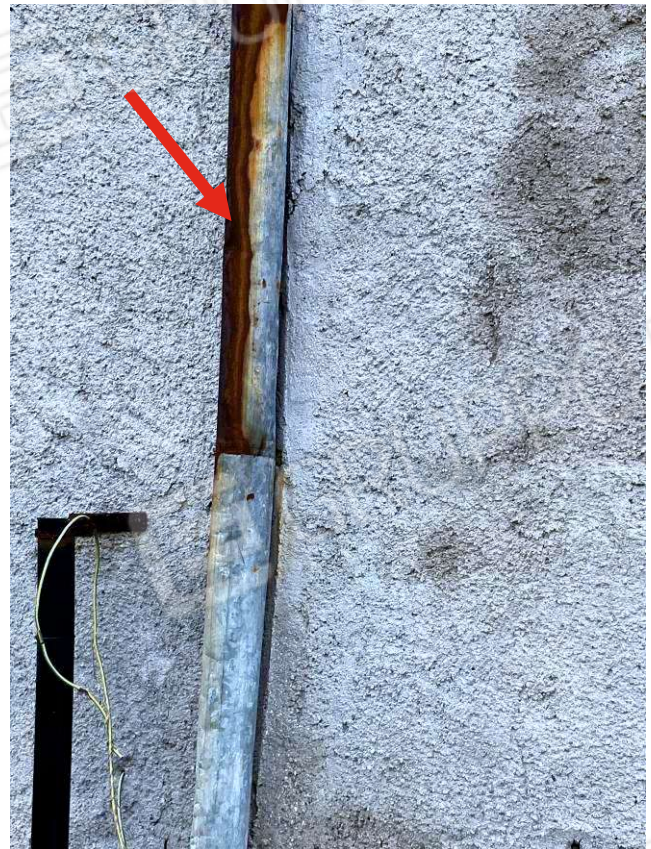
ulteriore vista degrado dello scarico pluviale
