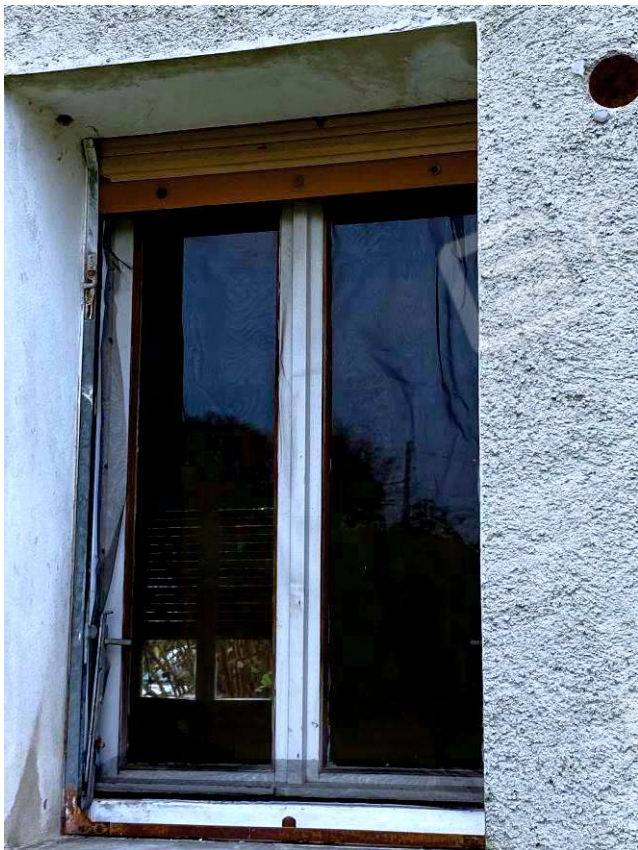
vista degrado vetusti serramenti ed avvolgibili
