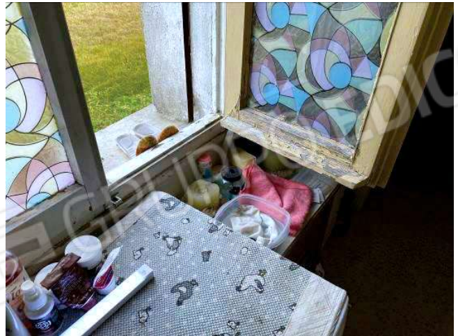
vista degrado delle finestre al primo piano
