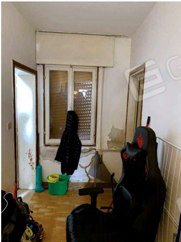
vista degrado intonaco nel disimpegno
