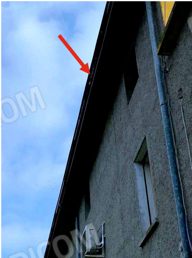
vista degrado delle grondaie
