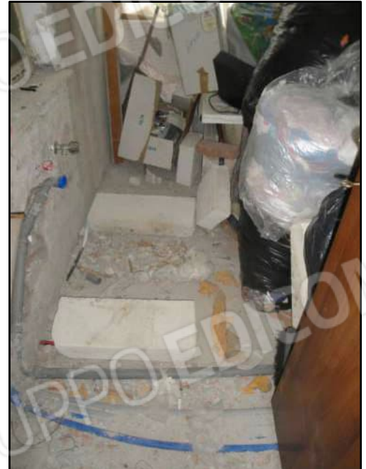
FOTO N. 13 BIS BAGNO IN CAMERA NON REALIZZATO
