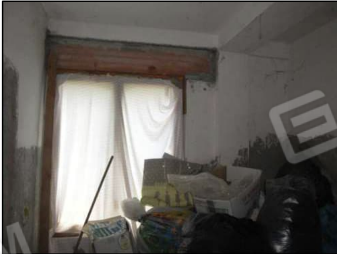
FOTO N. 13 BAGNO IN CAMERA 1 NON REALIZZ.
