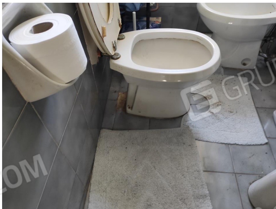
Viste parziali interne del bagno a piano primo in cui si evincono le rifiniture
