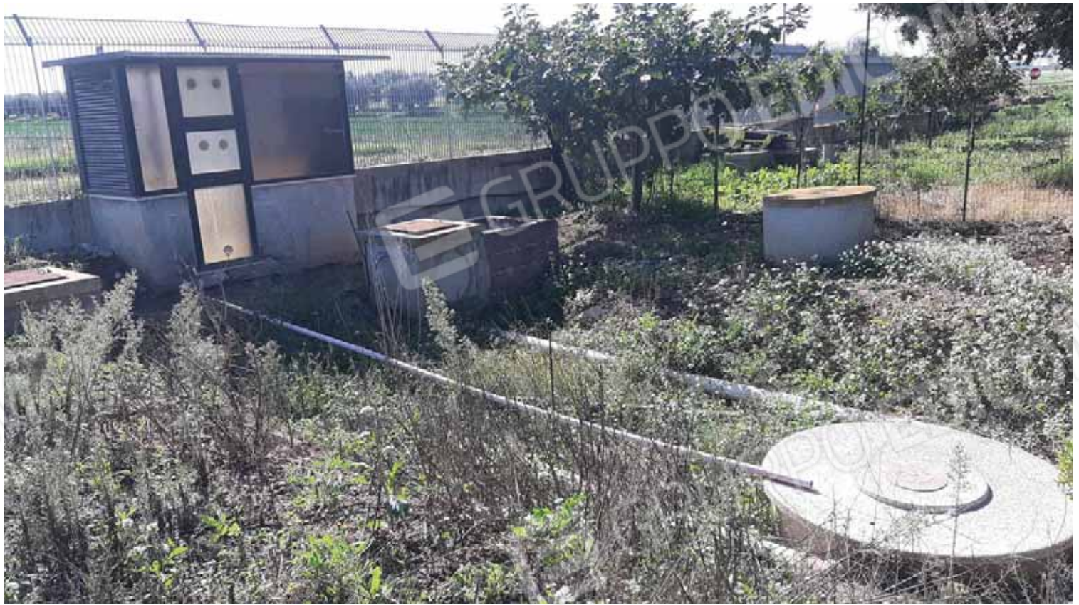
Foto terreno, Foglio 123, part. 45/59/100, impianti tecnologici
