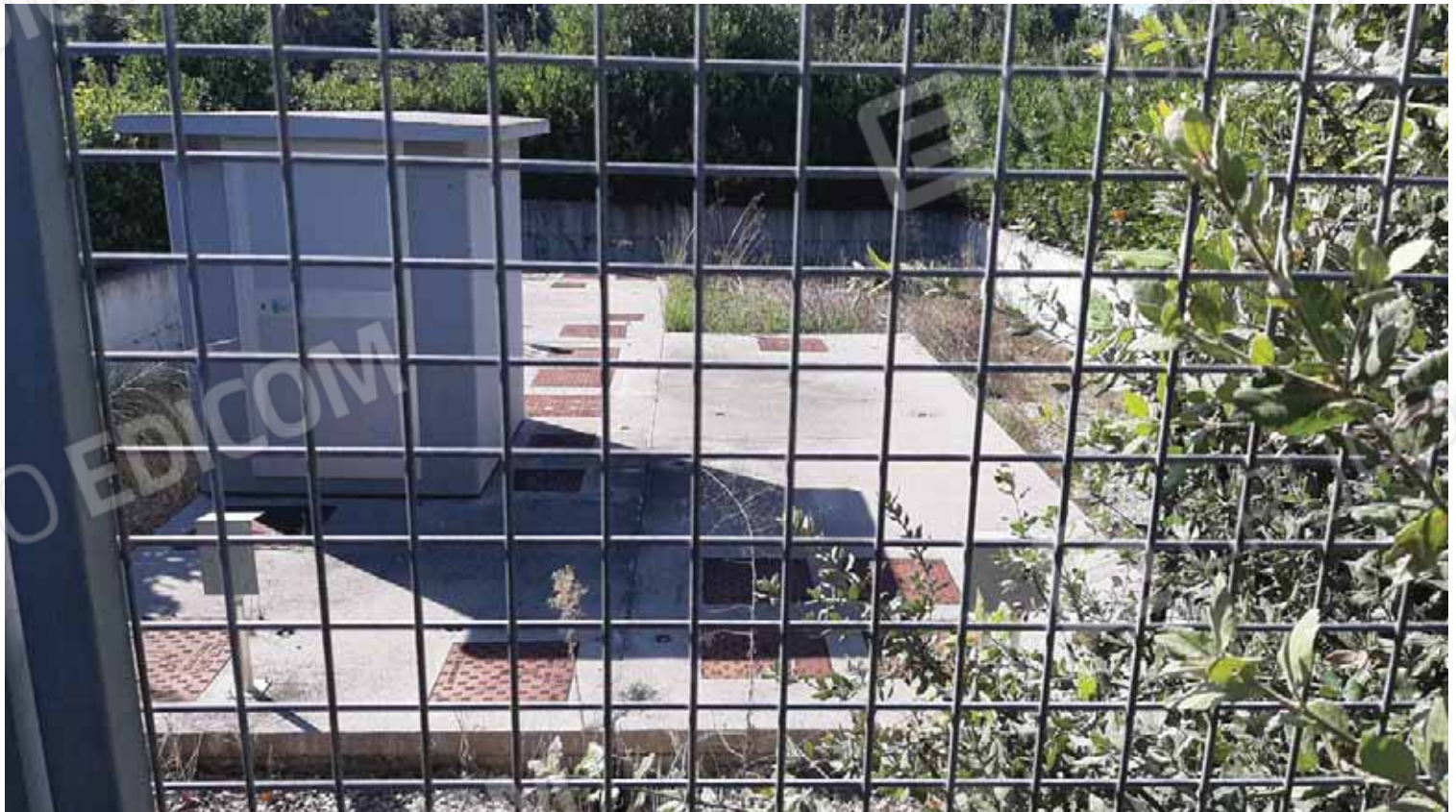
Foto terreno, Foglio 123, part. 45/59/100, impianti tecnologici.
