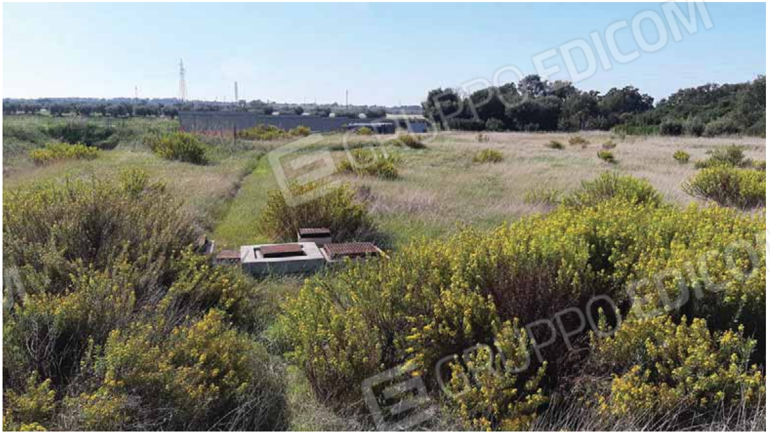
Foto terreno Foglio 123, part. 45/59/100, impinti tecnologici.
