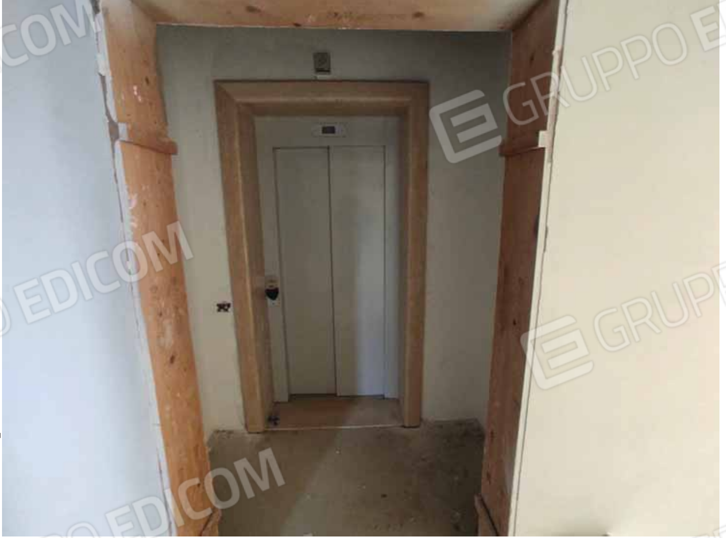
Ascensore piano terra
