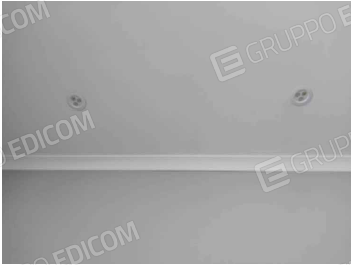
Esempio di illuminazione a soffitto
