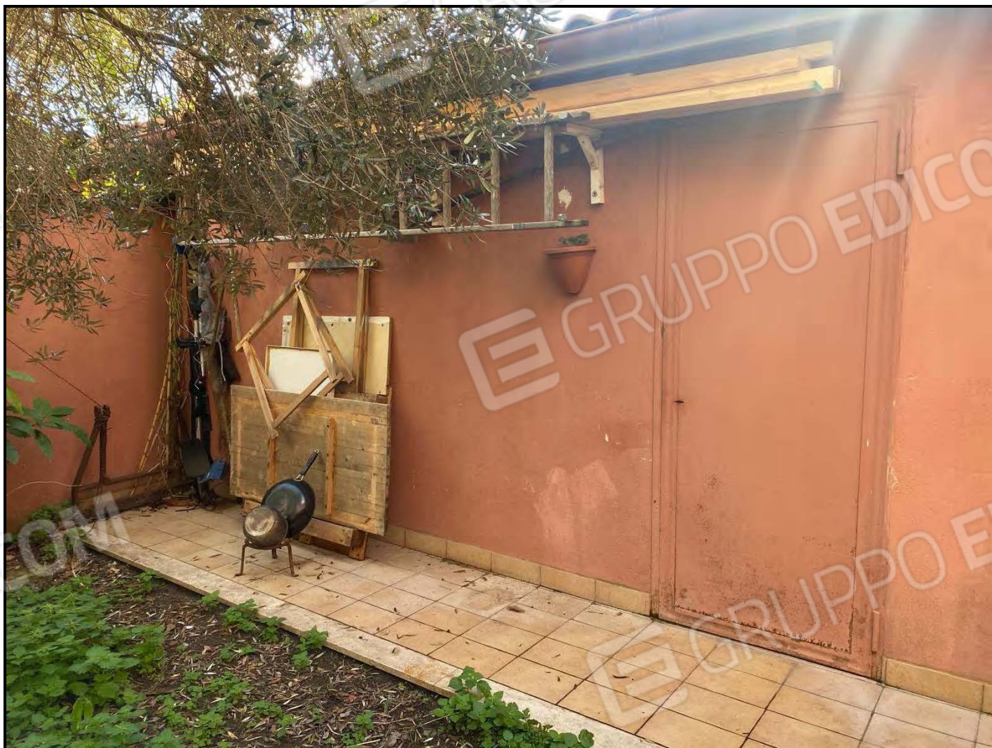
Locale magazzino abusivo
