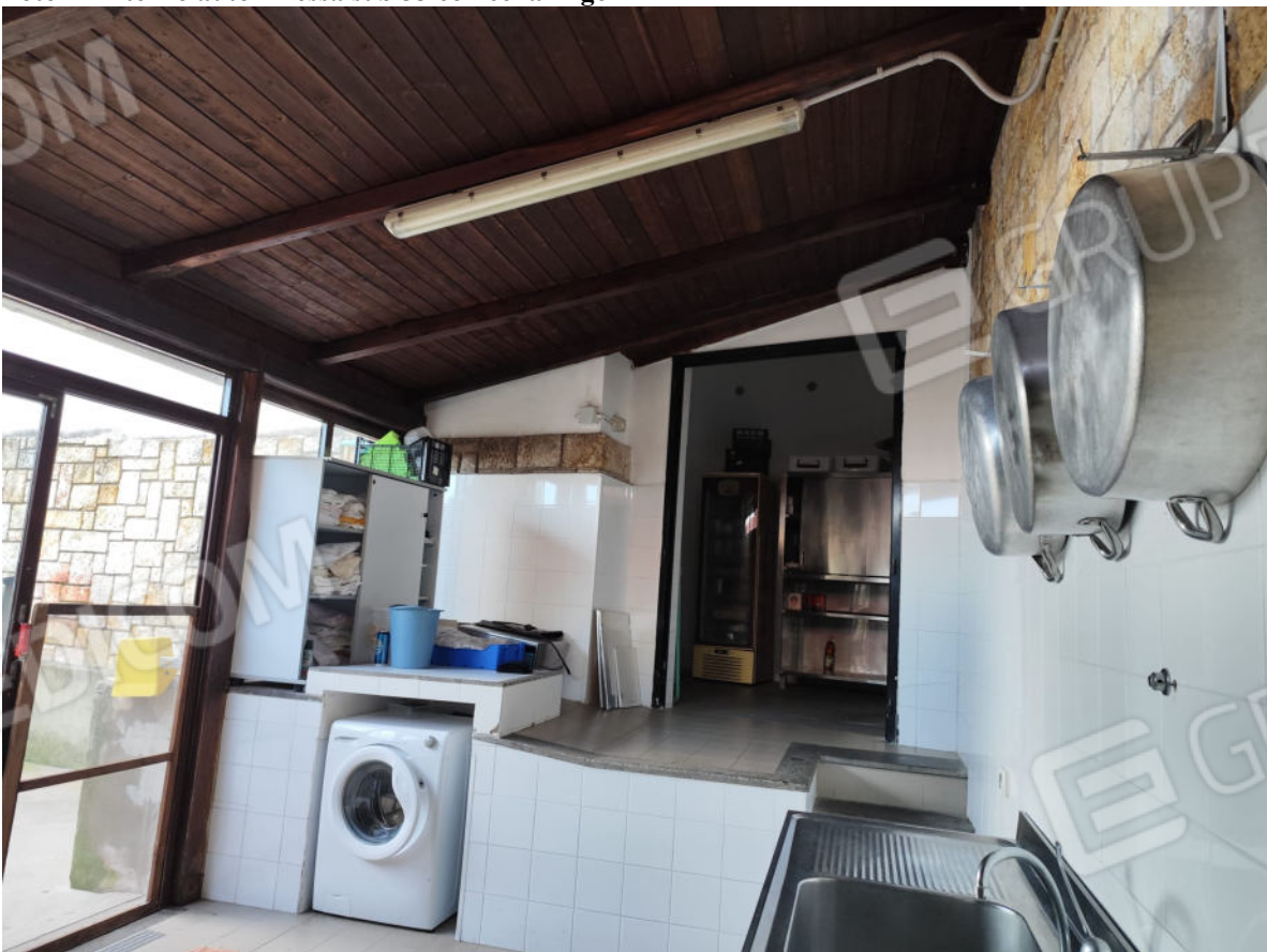
Foto 12 ampliamento abusivo cucina del ristorante sub 30
