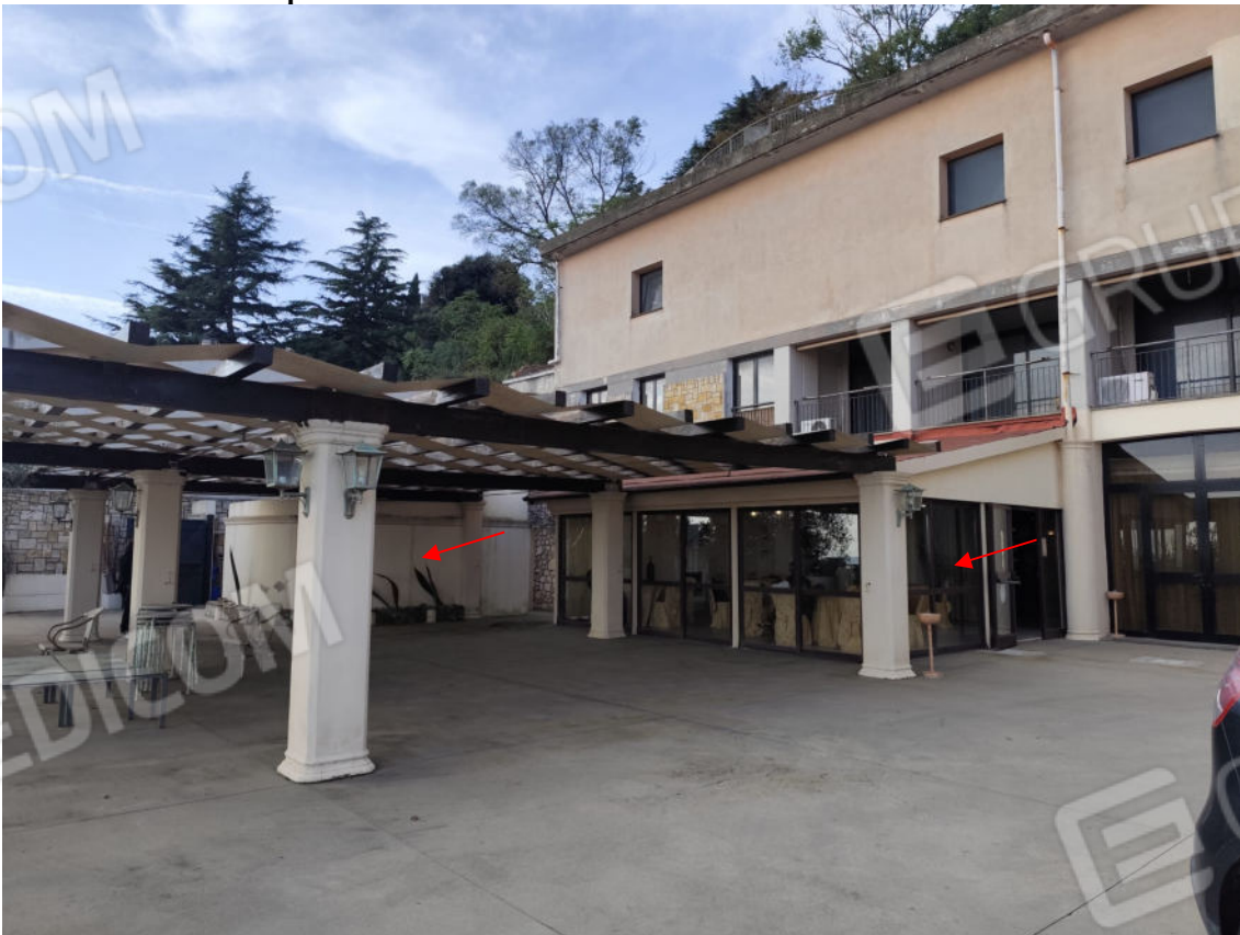
Foto 6 prospetto del ristorante con i volumi abusivi
