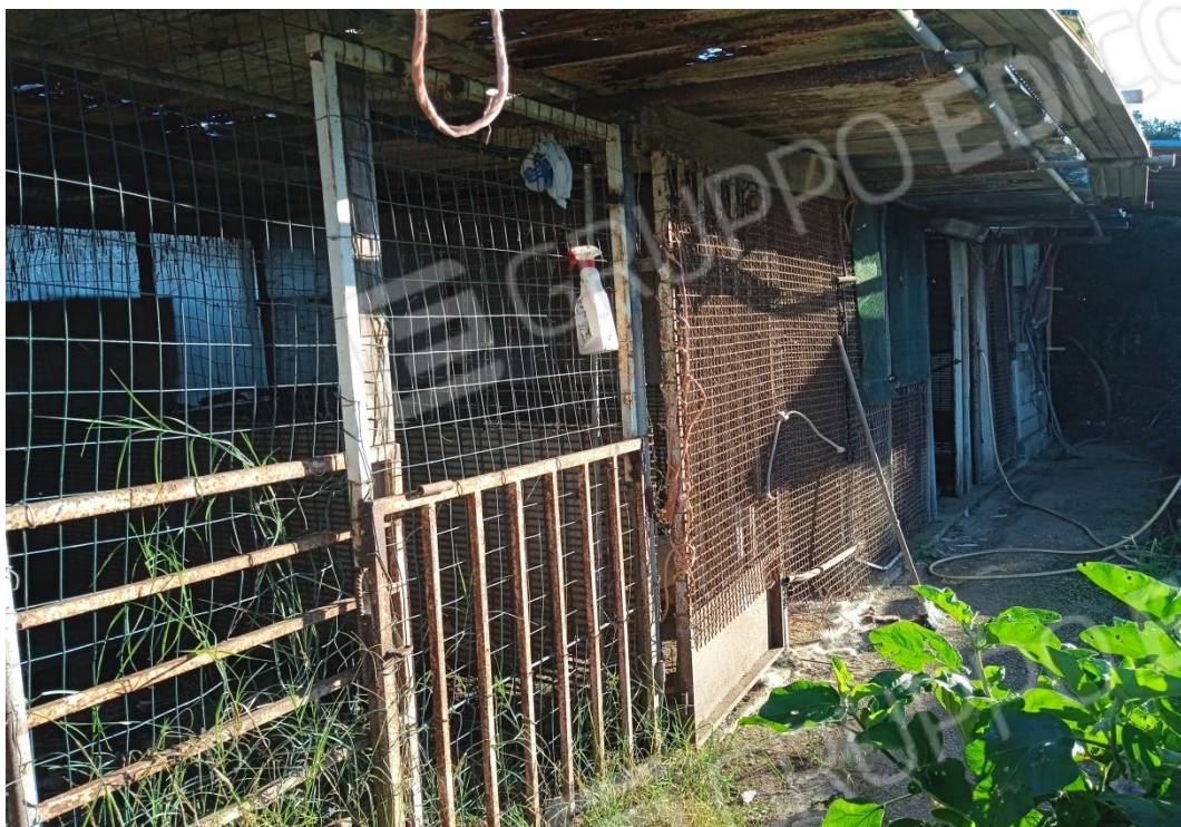
Foto n. 25 – tettoia tamponata con pannelli , grate, etc. sulla part.lla 777
