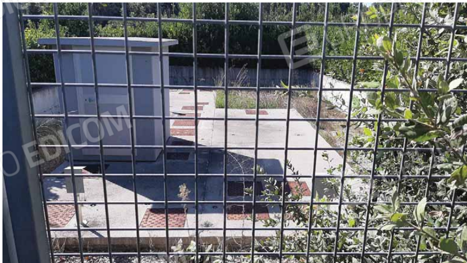
Foto terreno, Foglio 123, part. 45/59/100, impianti tecnologici.
