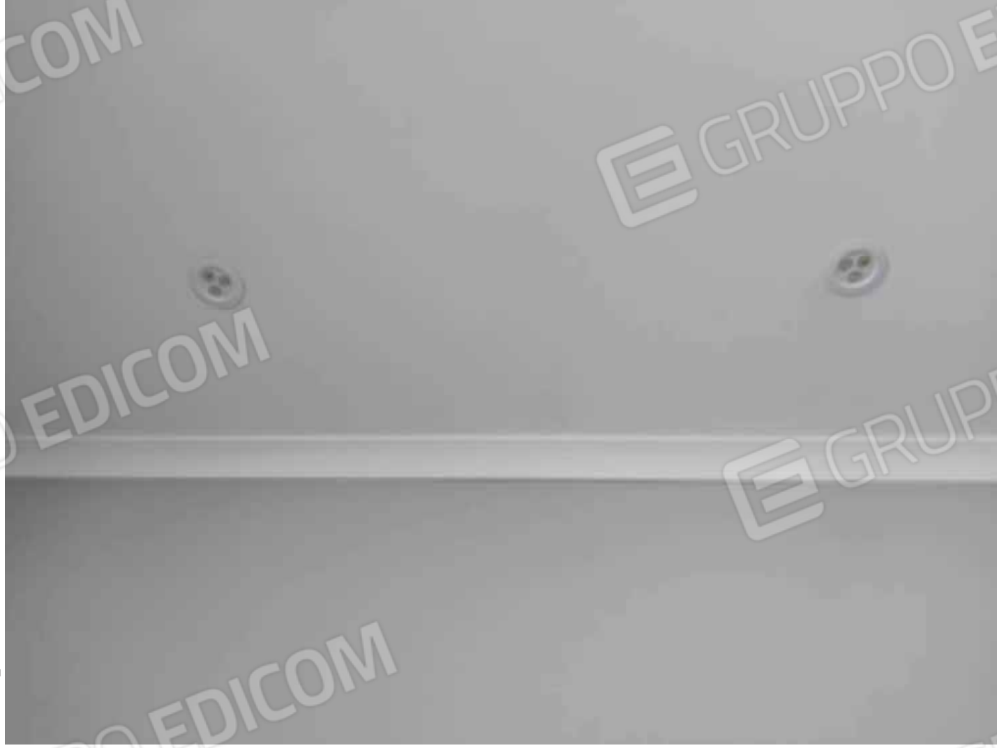
Esempio di illuminazione a soffitto
