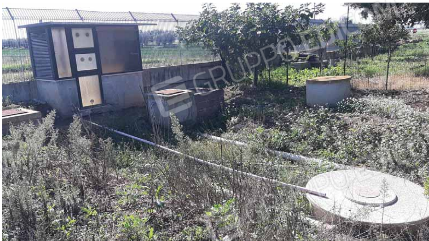
Foto terreno, Foglio 123, part. 45/59/100, impianti tecnologici
