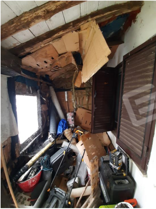
Manufatto abusivo da rimuovere
