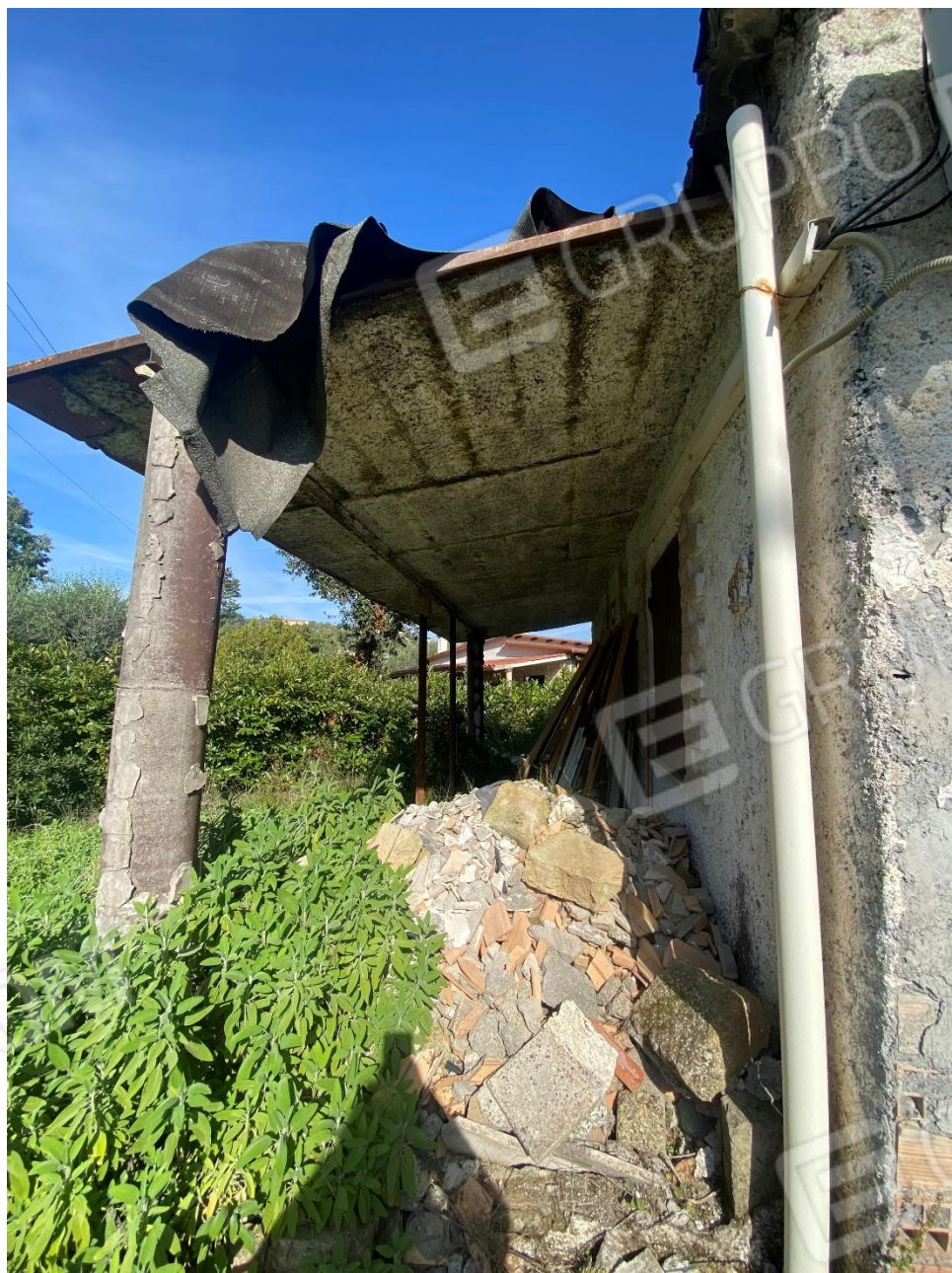
4. Zona Portico con materiali di risulta accantonati
