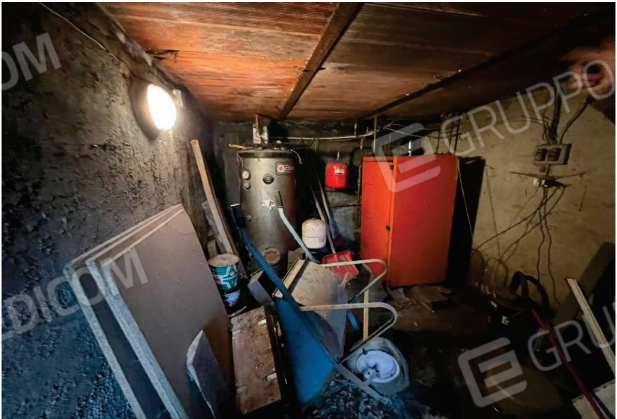
FOTO 16: Veduta interna lotto 2 corpo A: locale C.T.
