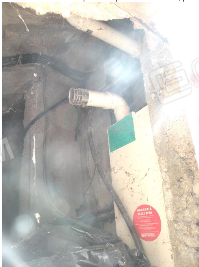
FOTO N°31: Vista interna dell'intercapedine al piano seminterrato, particolare caldaia.
