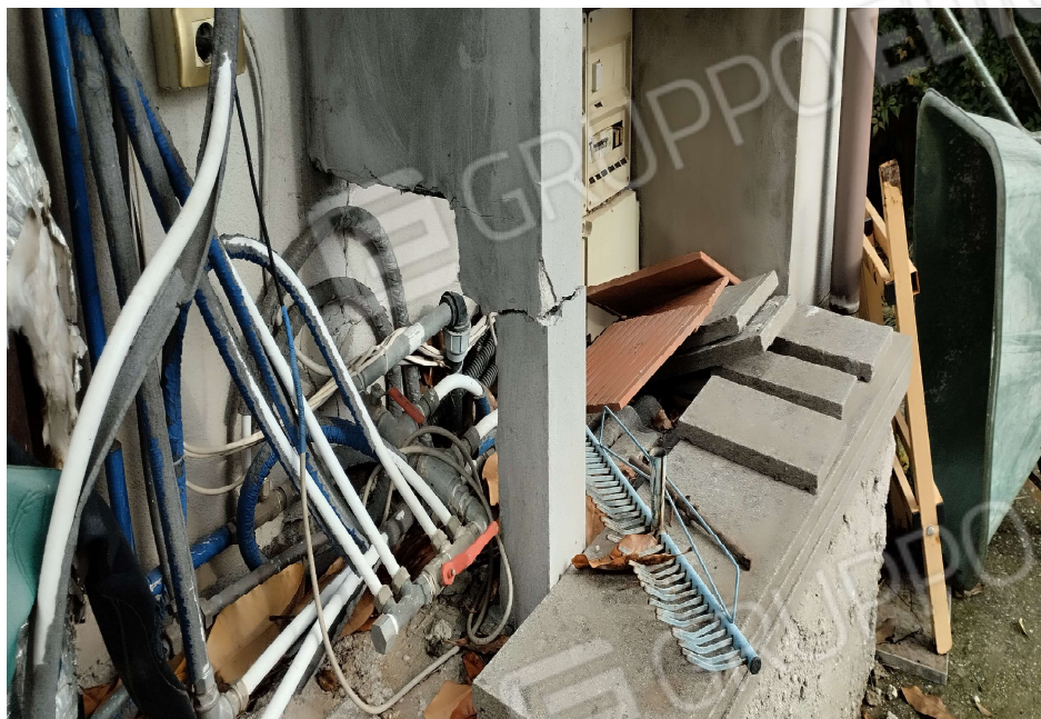
Particolare lesioni/cedimenti sul lato sud dello stabile principale
