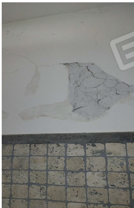
Vista lesioni al bagno
