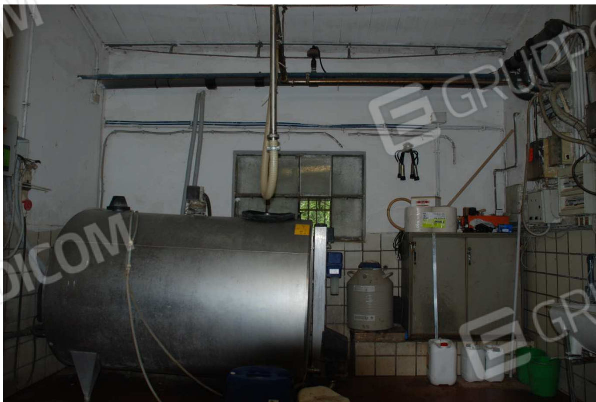
N - Stalla (particolare sala frigo latte)
