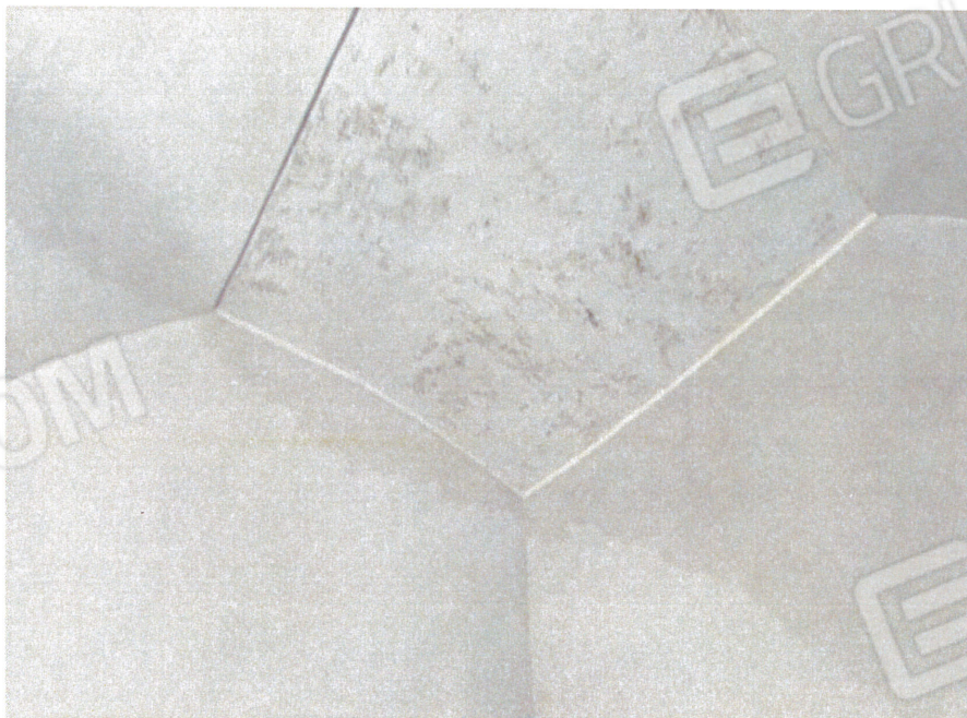
Altra vista macchie di umidità nella camera
