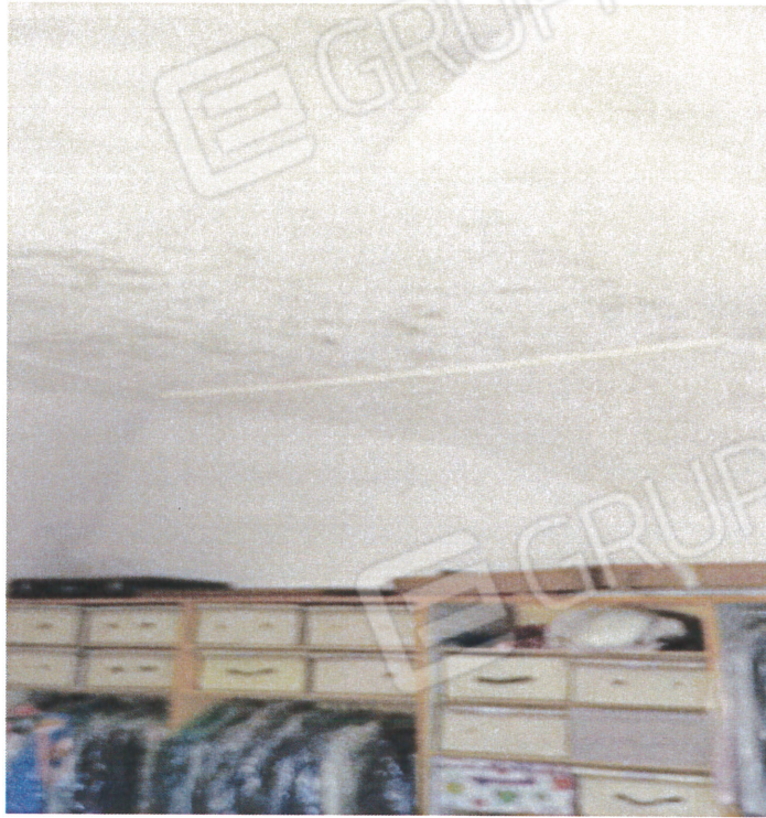
Vista soffitto camera con macchie di umidità
