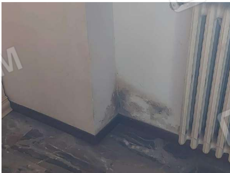
Foto n.10) Veduta particolare umidità in soggiorno
