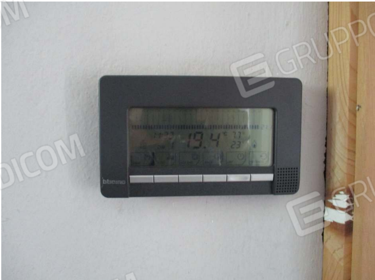
Fig. 48 – Vista del termostato digitale installato al P. primo
