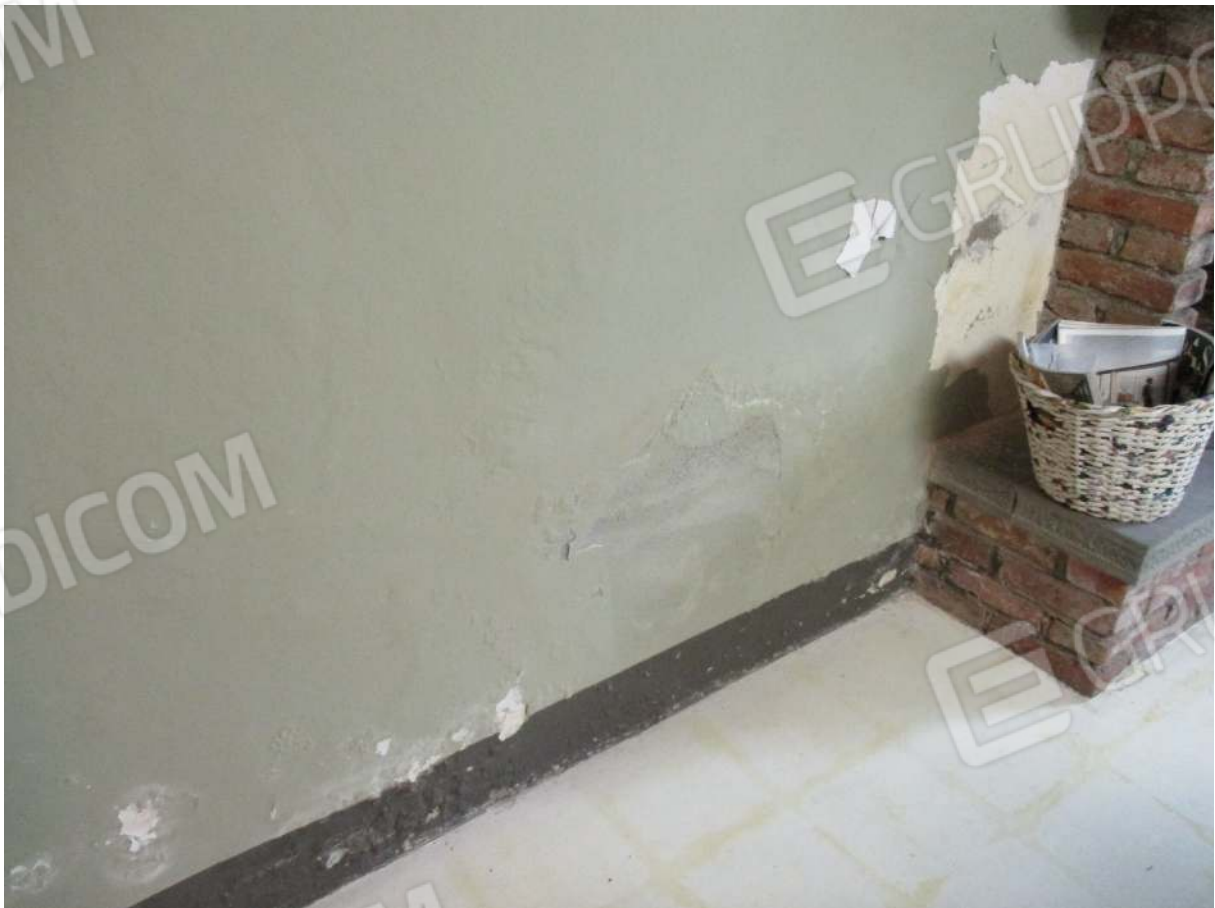
Fig. 20 – Vista di tracce di umidità da risalita sul muro della sala da pranzo
