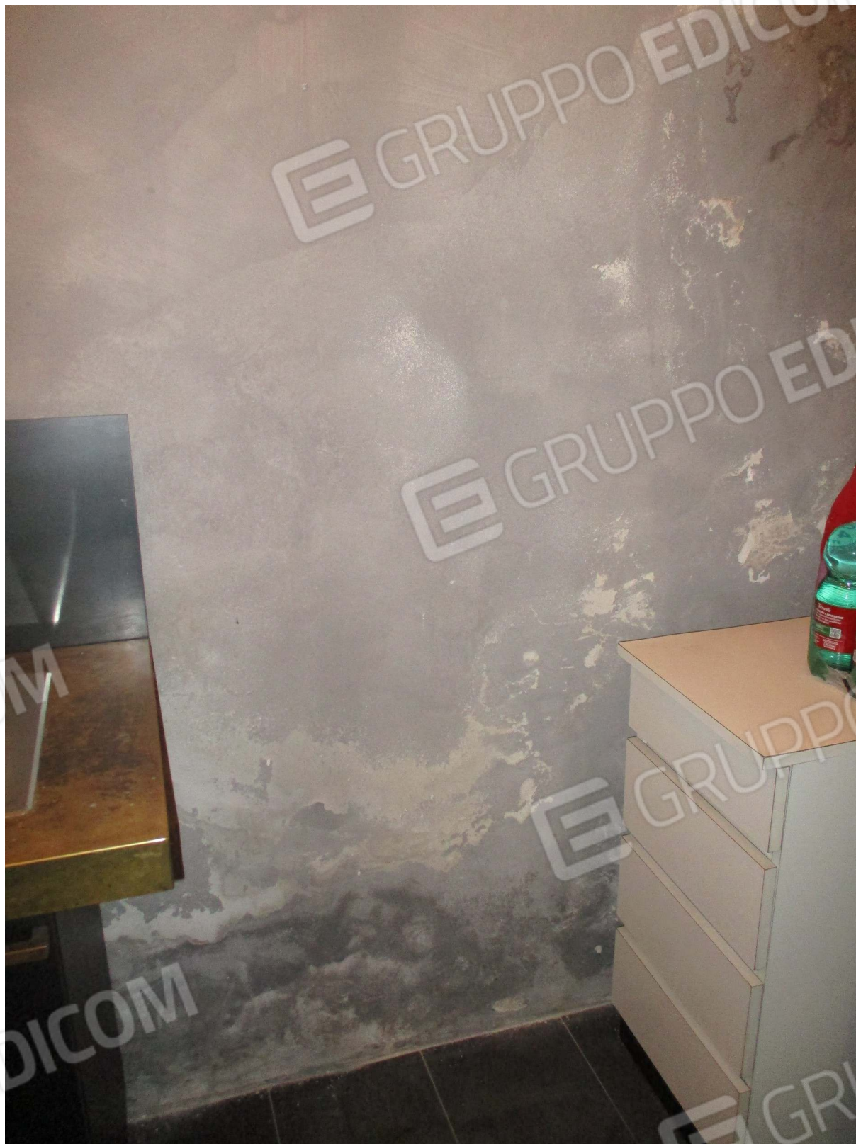
Fig. 22 – Vista di tracce di umidità da risalita sul muro della cucina
