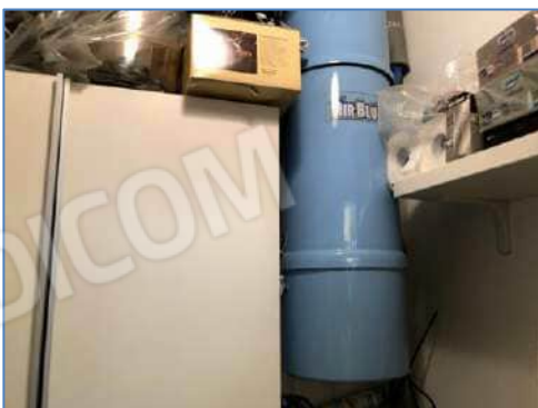
Foto 4.21: Bidone dell'aspiratore centralizzato
