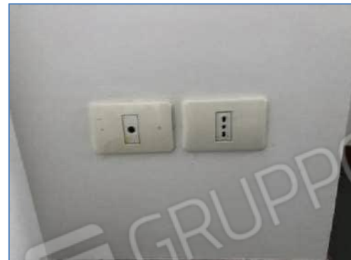
Foto 8.10: particolare prese elettriche
