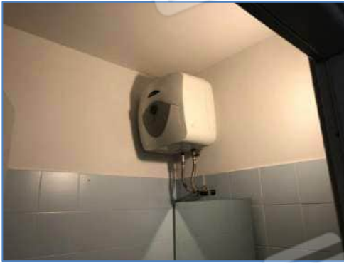
Foto 3.9: Boiler nel bagno
