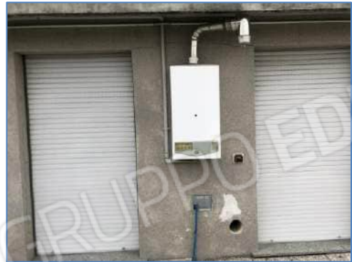
Foto 7.16: Caldaia pensile sul terrazzo
