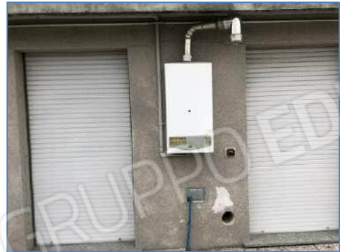
Foto 7.16: Caldaia pensile sul terrazzo
