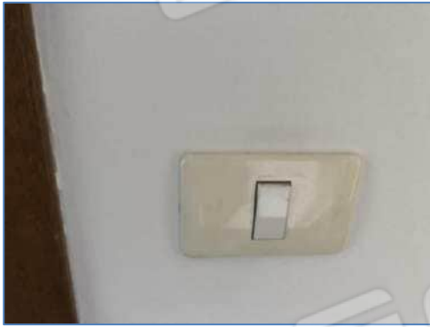
Foto 7.13: particolare interruttore elettrico
