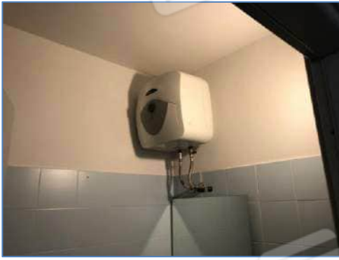
Foto 3.9: Boiler nel bagno
