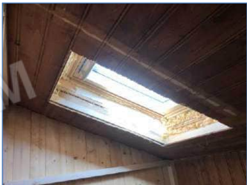
Foto 1.37: Nuovo velux nel bagno al P.2
