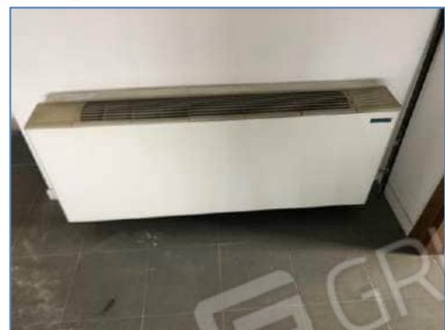
Foto 6.16: Terminali erogazione aria
