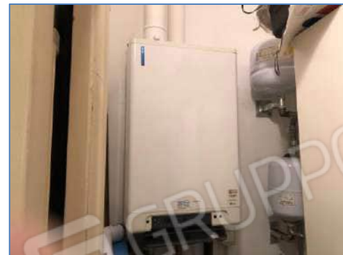
Foto 4.20: Caldaia nel ripostiglio
