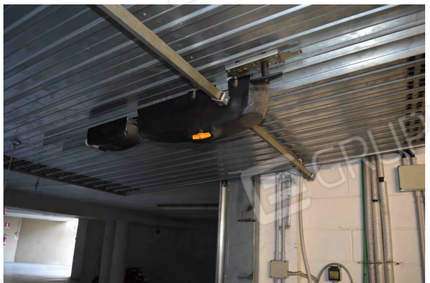
Autorimessa, automatismo serranda.
