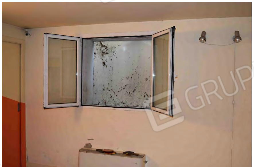
P.I. - Magazzino/Sala Giochi, ventilazione.
