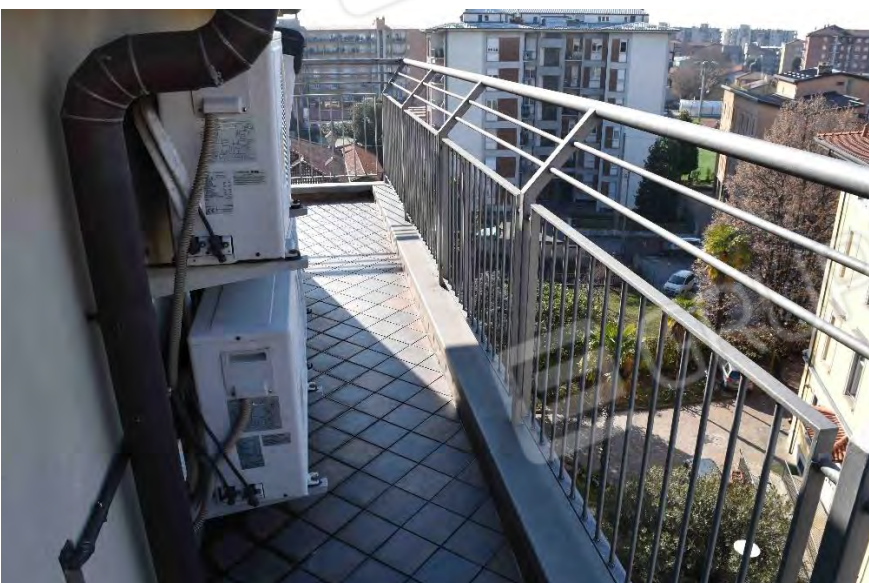
Balconata Ovest, impianti tecnici.
