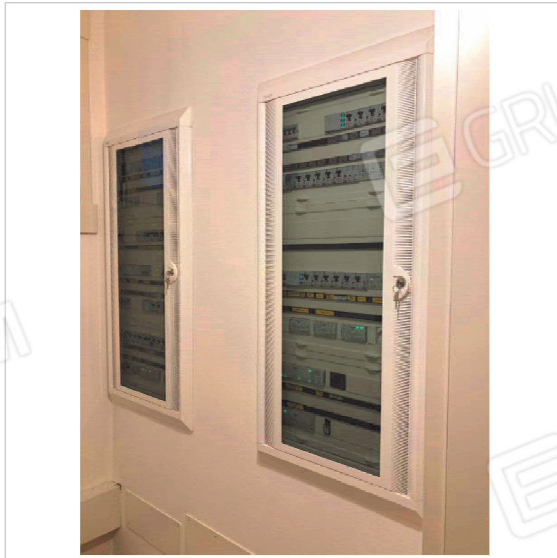
I quadri elettrici nel locale tecnico
