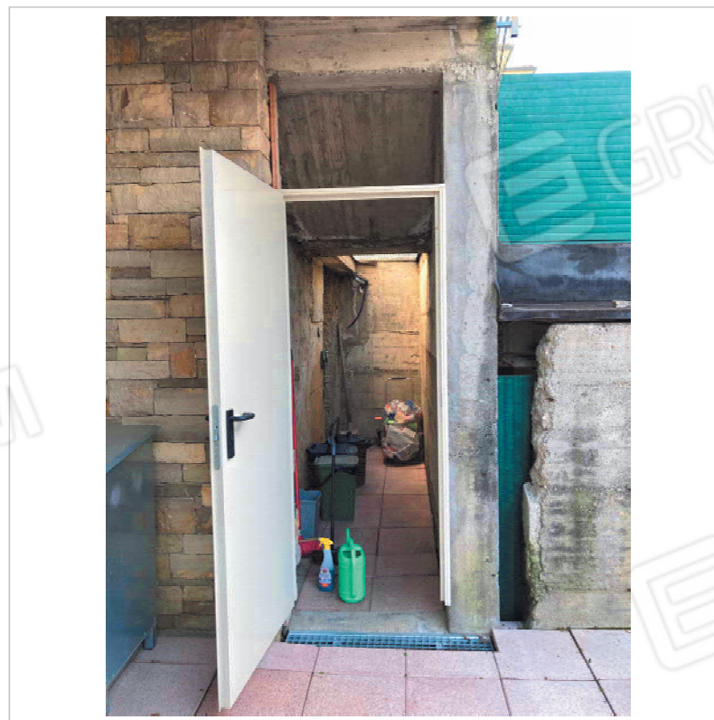
L'accesso alla caldaia
