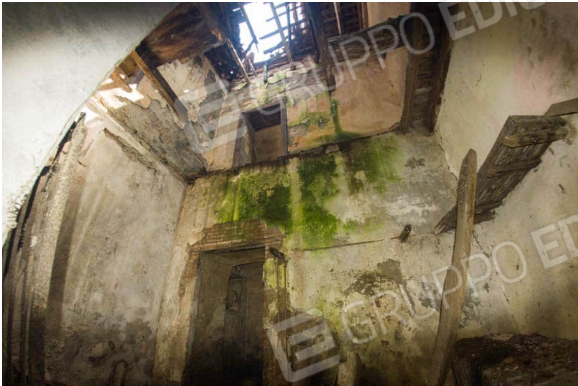
Solaio e tetto crollati muri ammalorati
