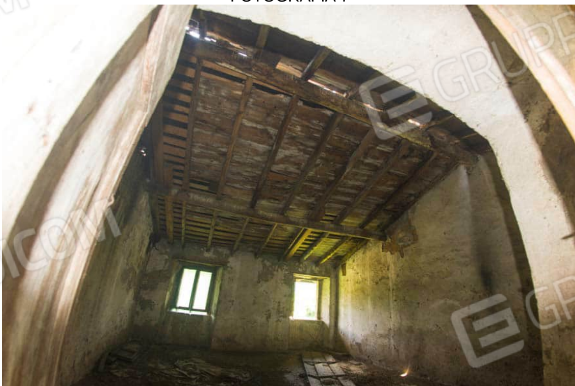
Tetto ammalorato, solaio imbarcato e sfondato
